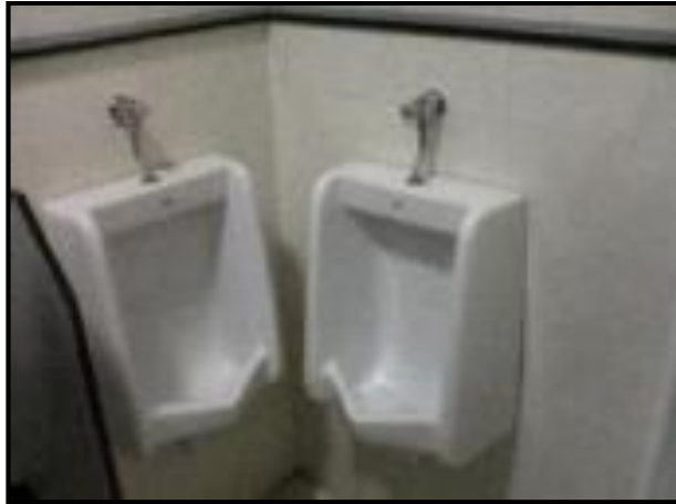
Imagen No 01: Mal diseño y construcción por defectos de diseño en baño
