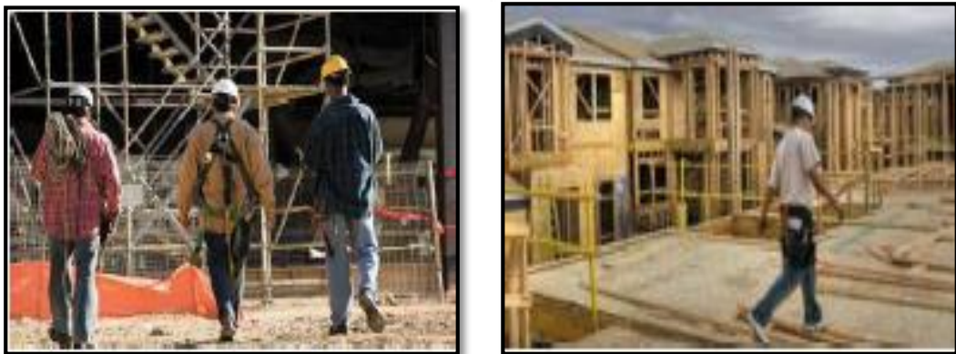
Imagen No 05: Pérdida: Movimiento de trabajadores del lugar de trabajo.
