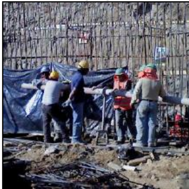
Imagen No 03: Pérdida: Espera para vaciar por falta del mixer.
