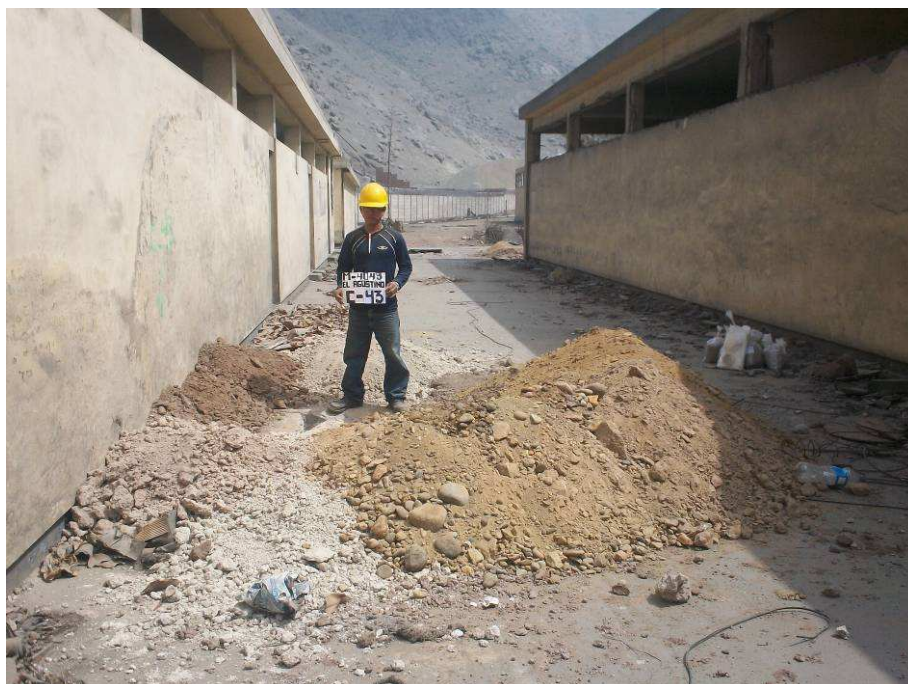
UBICACIÓN DE LA CALICATA C-43. SE APRECIAN LOS SUELOS FINOS EXTRAIDOS DE LA EXCAVACION.
