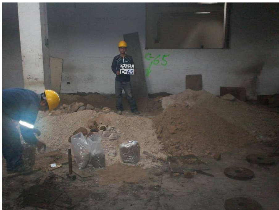
UBICACIÓN DE LA CALICATA C-65. SE APRECIAN LOS SUELOS EXTRAIDOS DE LA EXCAVACIÓN Y LAS MUESTRAS ALTERADAS E INALTERADAS TOMADAS.
