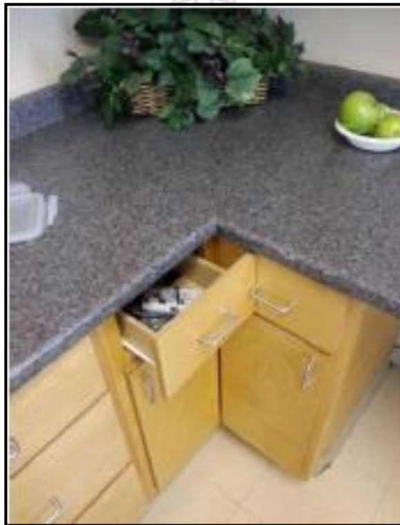
Imagen No 02: Mal diseño y construcción por defectos de diseño en cocina
