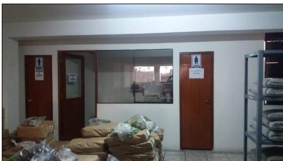
Figura 182. Señalización de puertas - después
