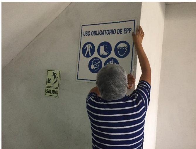
Figura 131. Señalización de uso de EPP'S
