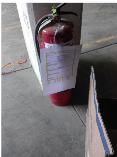
Figura 110. Tarjeta amarilla para el extintor
