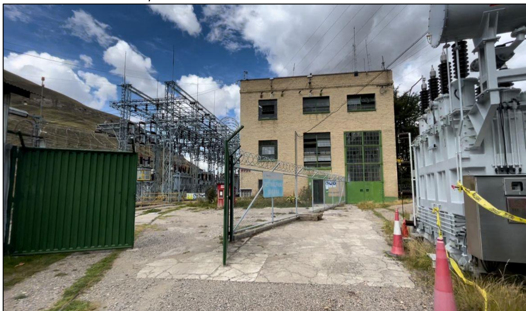
Figura. 21 Central hidroeléctrica Malpaso
