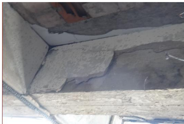
Figura 13. Desprendimiento del concreto
