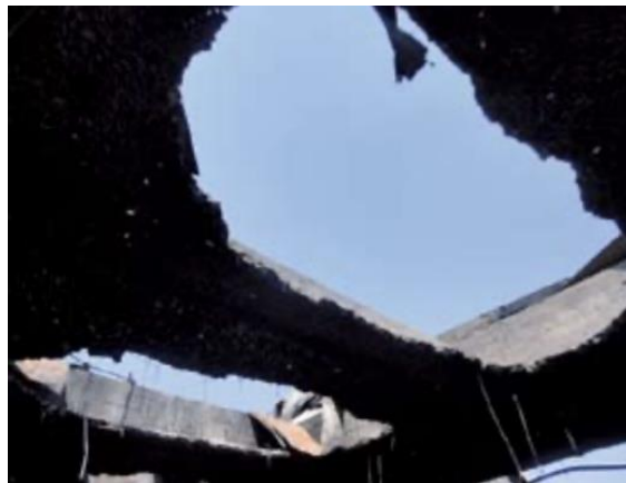
Figura 15. Colapso de Losa
