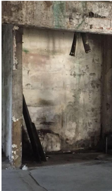
Figura 18. Incendio en edificio Nicolini
