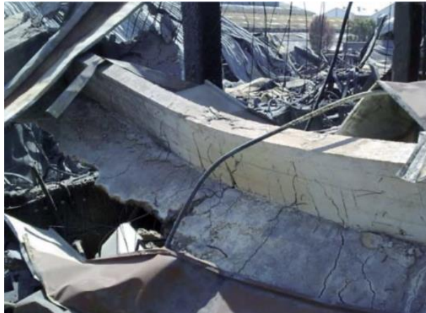
Figura 14. Colapso de Viga
