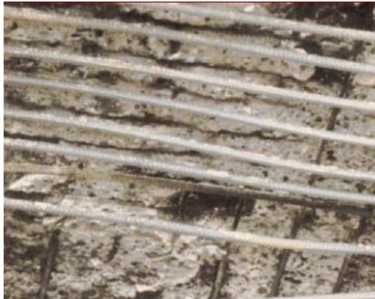
Figura 17. Desprendimiento de recubrimiento en losas de concreto
