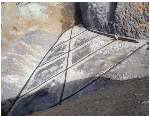
Figura N°06. Sistema de drenaje subterráneo, una tubería de HDPE corrugada y perforada de 6" de diámetro y forrado con geotextil.
