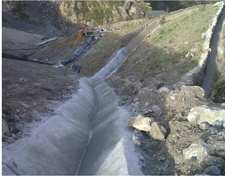
Figura N°07. Canal de coronación y cunetas para captar y descargar las aguas producto de las precipitaciones pluviales.
