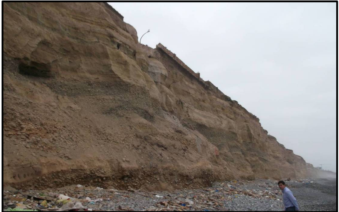
Figura N° 08. Interacción de la erosión marina, eólica y la brisa marina. Altura del Colegio Militar Leoncio Prado donde se evidencia la interacción de la erosión marina, eólica y la brisa marina, se puede observar en la parte superior del talud a parte de la base de las aceras colgadas a punto de colapsar, debido a la erosión del talud inferior por acción de la erosión marina y las partes superiores en menor escala por la erosión eólica y la brisa marina.
