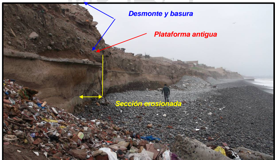
Figura N° 07. Talud con su base parcialmente erosionada, dejando colgado la sección superior, en la foto se observa que el remonte de las olas llega hasta la base del talud.
