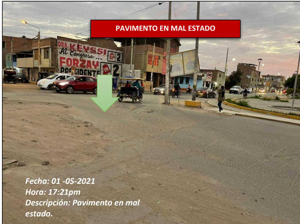
Figura 3: Pavimento en mal Estado
