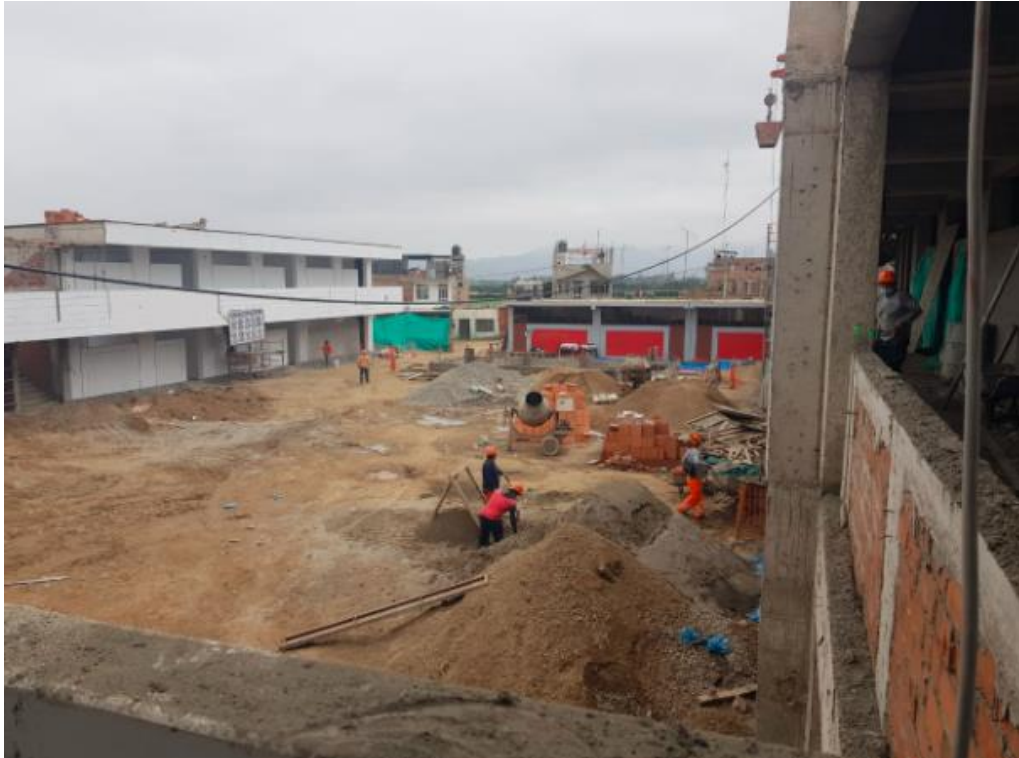
Figura 17. Mala distribución de los materiales en obra
