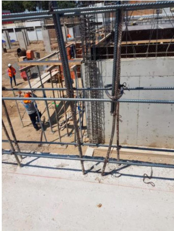
Figura 35. Mal colocado de acero en placa Elaboración: Los autores
