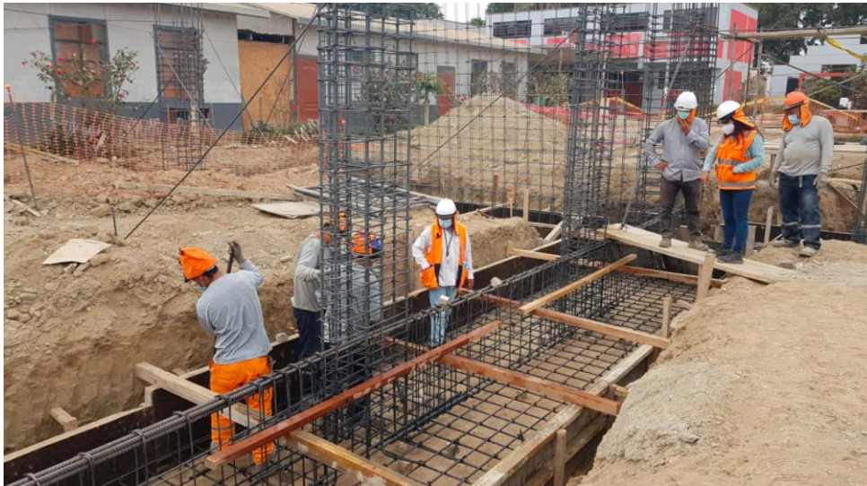
Figura 98. Acero alineado, distribuido de forma correcta y respetando el recubrimiento conforme indique el plano Elaboración: Los autores
