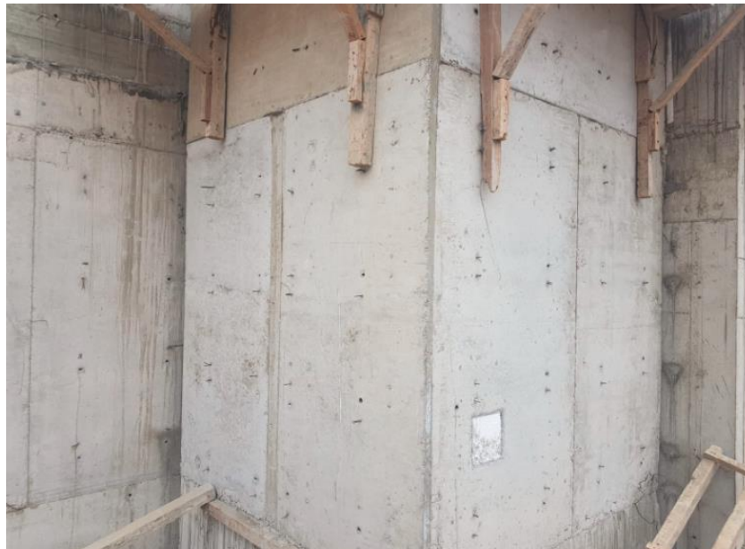
Figura 97. Elementos estructurales sin segregación y cangrejas Elaboración: Los autores
