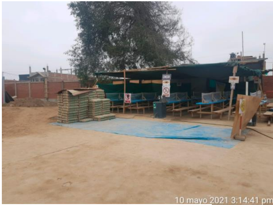
Figura 36. Falta de cemento en obra Elaboración: Los autores
