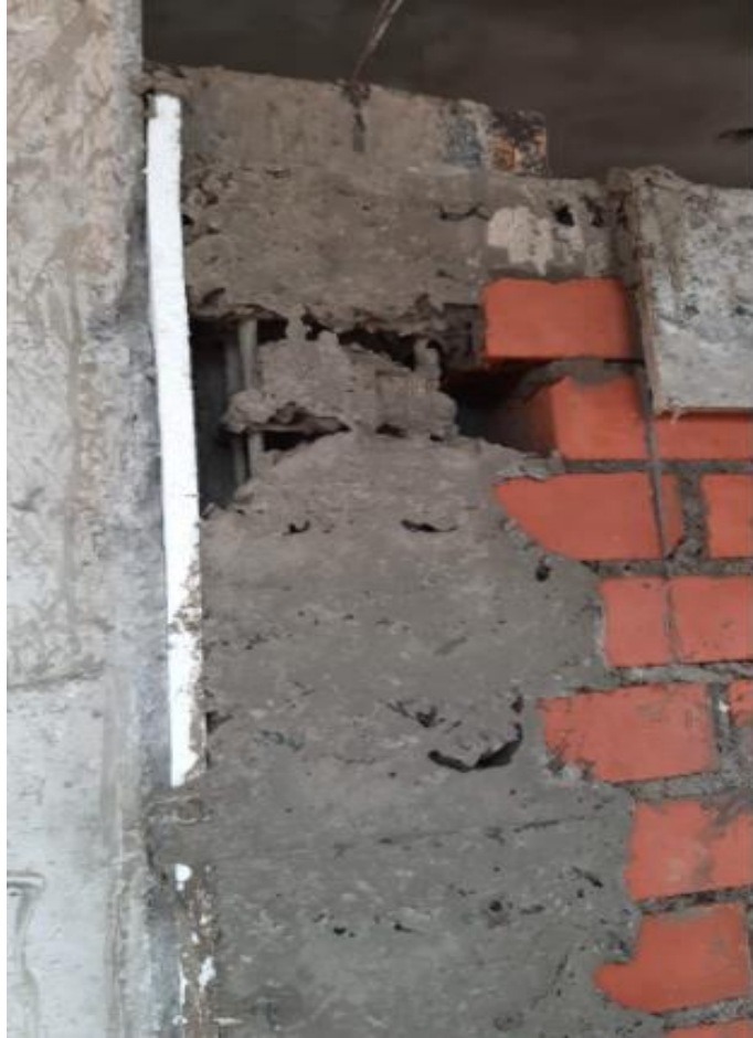
Figura 34. Presencia de acero en columneta Elaboración: Los autores
