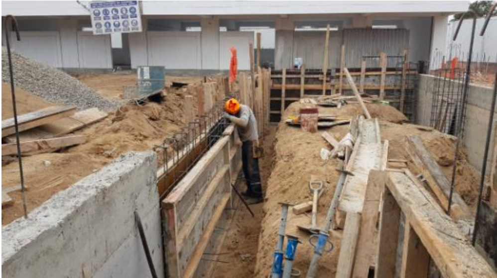
Figura 12. Falta de supervisión Elaboración: Los autores
