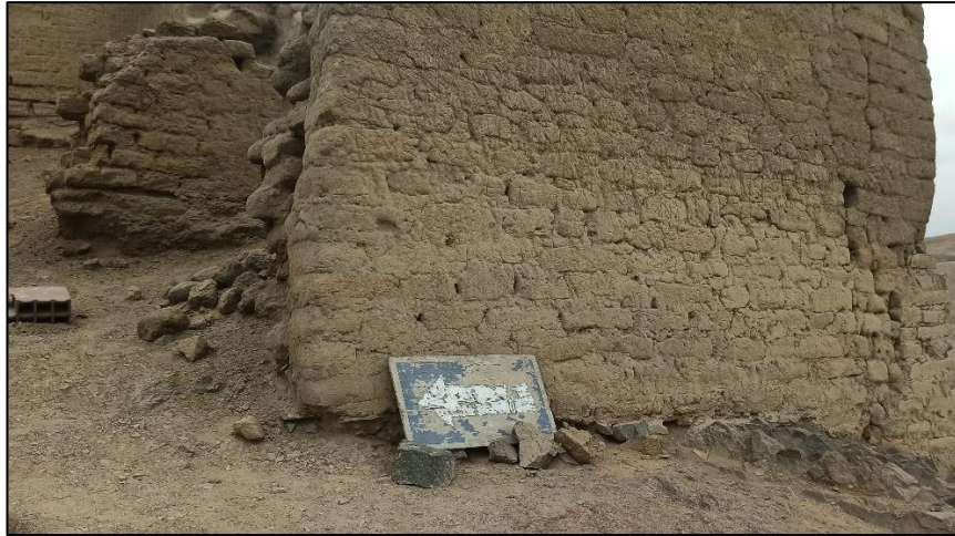
Figura N° 34. Señalética muy deteriorada que marca camino informal en la Fortaleza de Paramonga. Elaboración propia.
