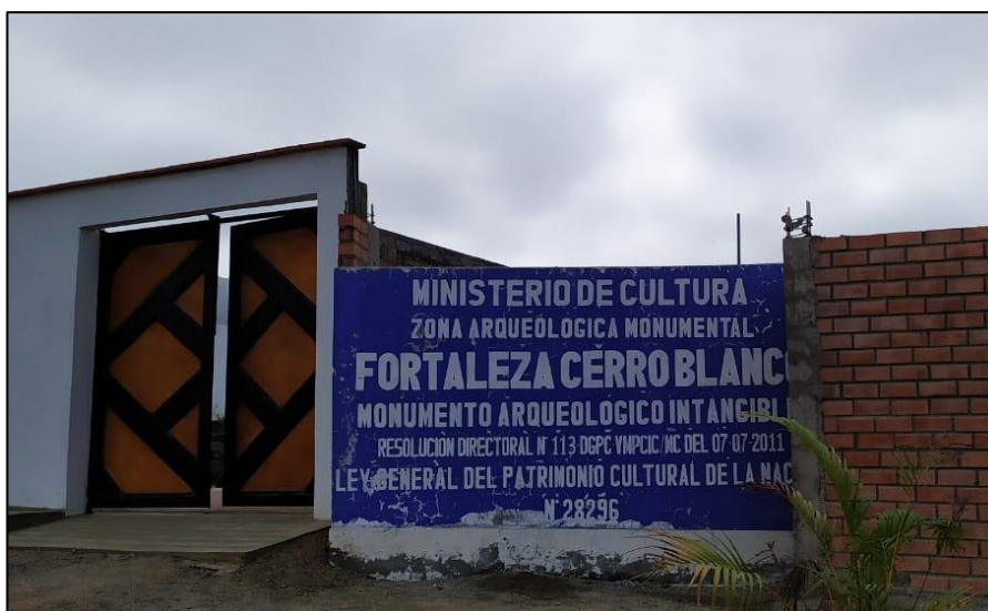
Figura N° 50. Detalle de muro oficial del Ministerio de Cultura que ha sido vandalizado y reutilizado como muro de una vivienda moderna. Elaboración propia.
