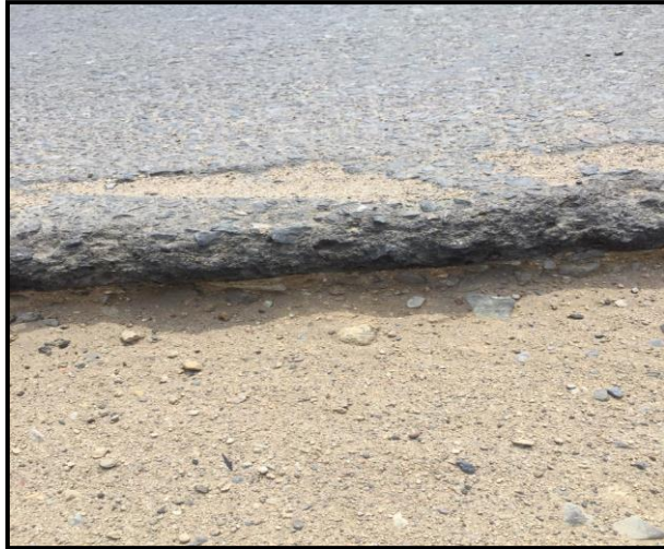
Figura 19. Desnivel de carril Elaboración los autores.
