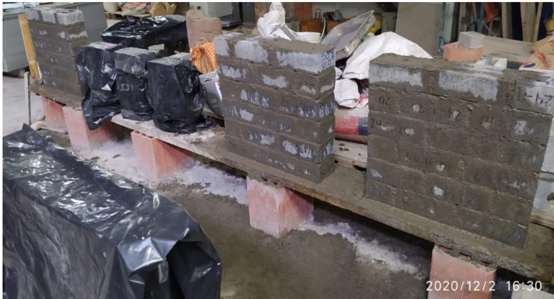
Figura 42. Elaboración de tres unidades de murete con ladrillo 50 % vidrio Fuente: Elaboración propia
