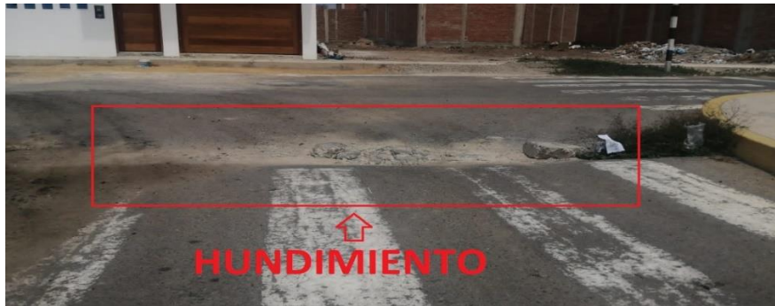
Figura N°11: Hundimiento de alta severidad, urbanización la ensenada Chiclayo (2020).
