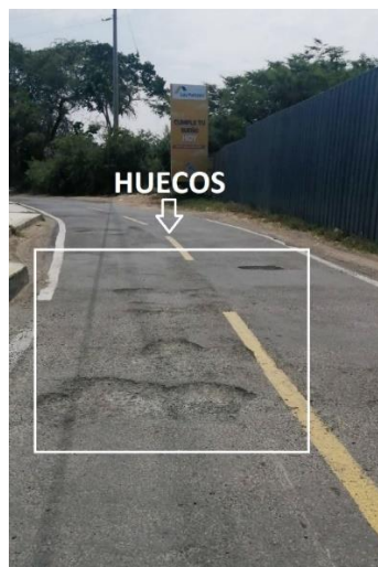
Figura N°20: Huecos media severidad, Urbanización Los portales, Chiclayo (2020).
