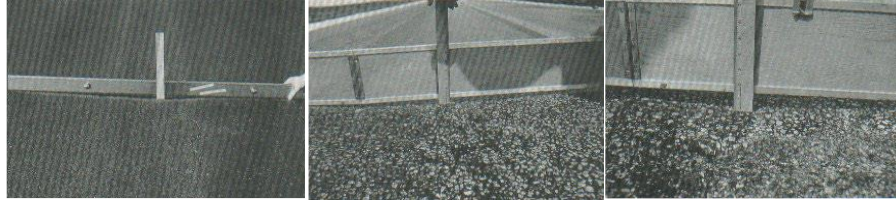
Figura N°22: De izquierda a derecha, falla por ahuellamiento de baja, media y alta severidad
