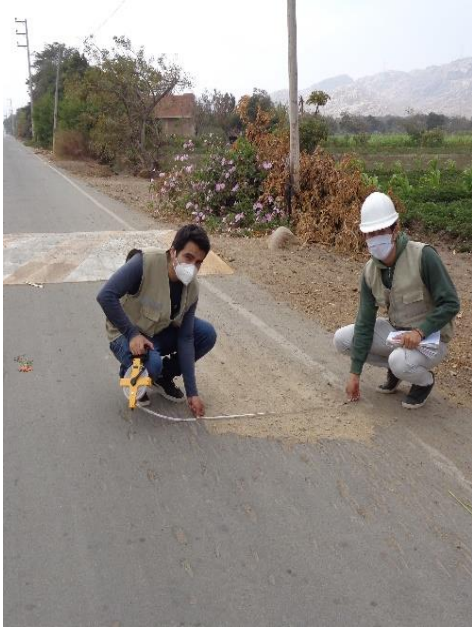
Hueco de alta severidad
