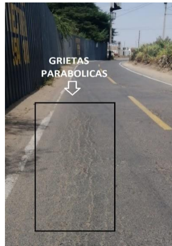
Figura N°24: Falla por grietas parabólicas, de media severidad, urbanización los portales Chiclayo (2020).
