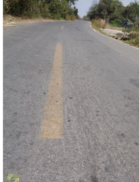
Grietas parabólicas de baja severidad
