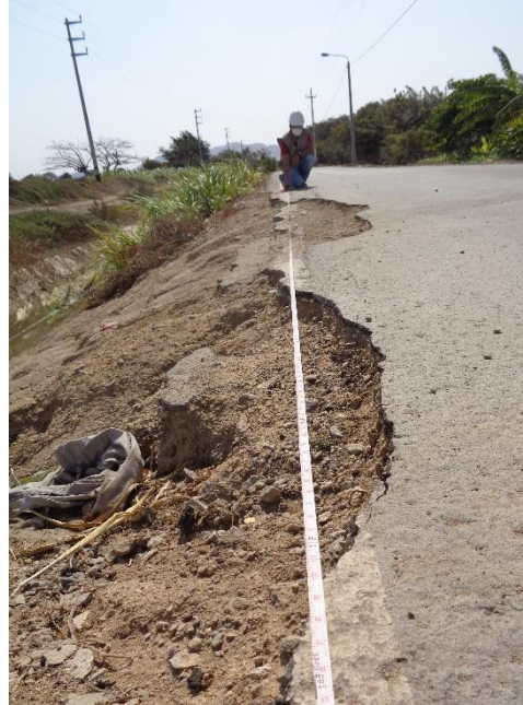
Grieta de borde de alta severidad
