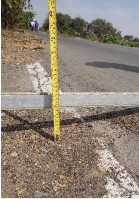
Hundimiento de media severidad
