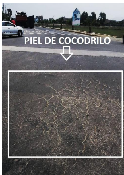
Figura N°08: Piel de cocodrilo, media severidad, entrada a la urbanización la ensenada, Chiclayo (2020).
