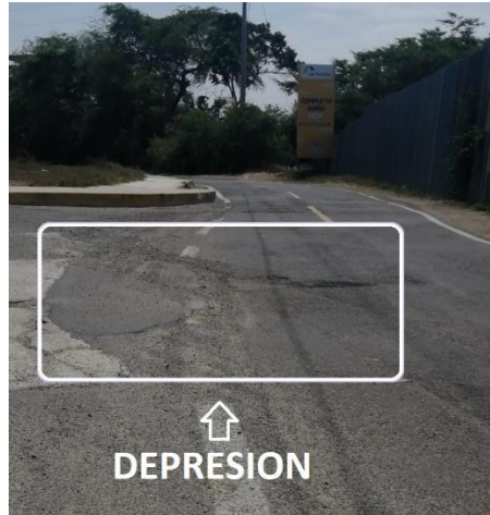
Figura N°13: Depresión de media severidad, urbanización los portales Chiclayo (2020).
