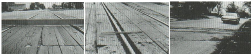
Figura N°21: De izquierda a derecha, falla en cruce de vía férrea de baja, media y alta severidad
