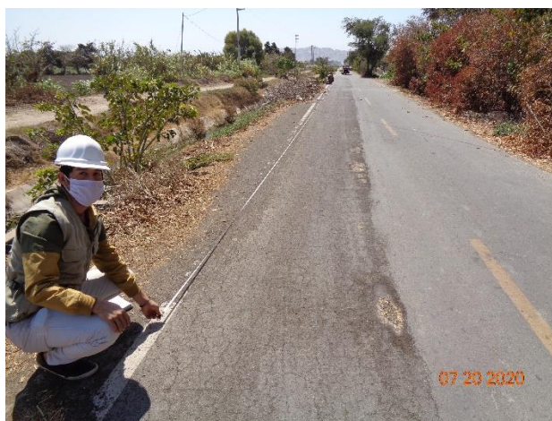
Figura N°38: Desprendimiento de agregados
