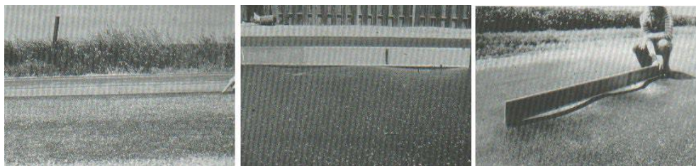
Figura N°12: De izquierda a derecha, falla por corrugación de baja, media y alta severidad
