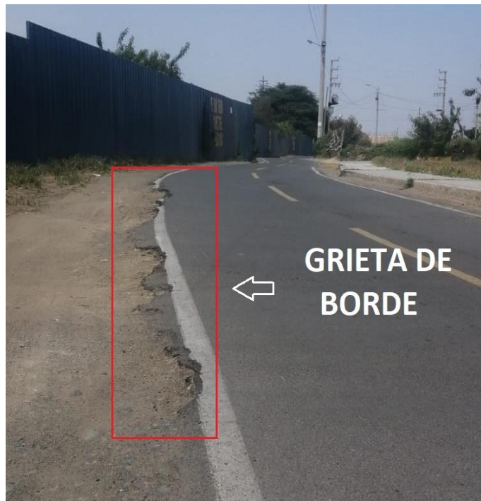
Figura N°14: Falla por Grieta de Borde de alta severidad Entrada a la Urb los portales, Chiclayo (2020).
