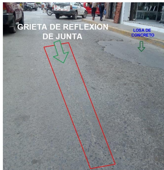
Figura N°15: Falla por grieta de reflexión de junta de baja severidad Calle Alfredo Lapoint, cuadra 2, Chiclayo (2020).
