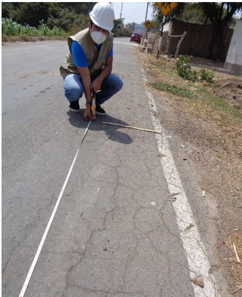
Agrietamiento en bloque de baja severidad
