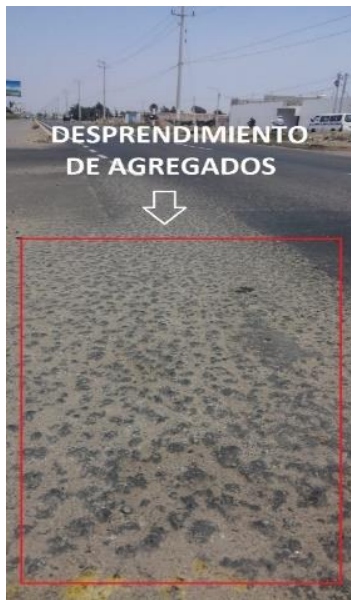
Figura N°26: Desprendimiento de agregados de media severidad carretera a Pimentel, Chiclayo (2020).
