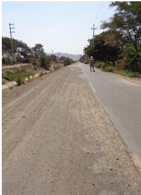
Desprendimiento de agregados de alta severidad
