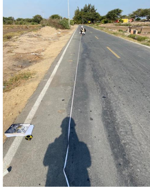
Exudación de baja severidad
