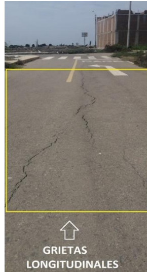
Figura N°17: Grietas longitudinales y transversales de baja severidad, calle 8 de la Urb la Encenada. Chiclayo (2020).
