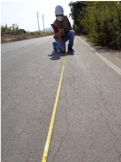
Grietas long/trans de media severidad
