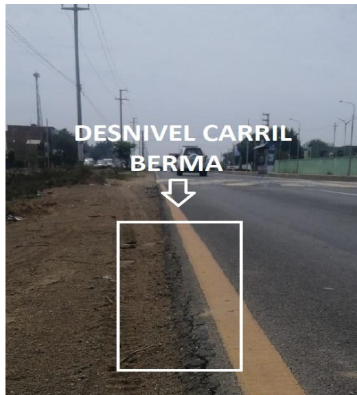
Figura Nº 16: Desnivel Carril-Berma, de media Severidad carretera Pimentel, Chiclayo (2020).
