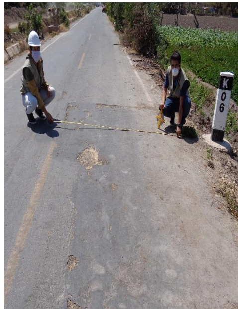
Parche de alta severidad
