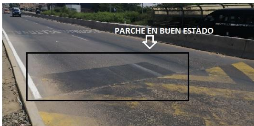
Figura N°18: Parche de baja severidad, carretera Pimentel, Chiclayo (2020).
