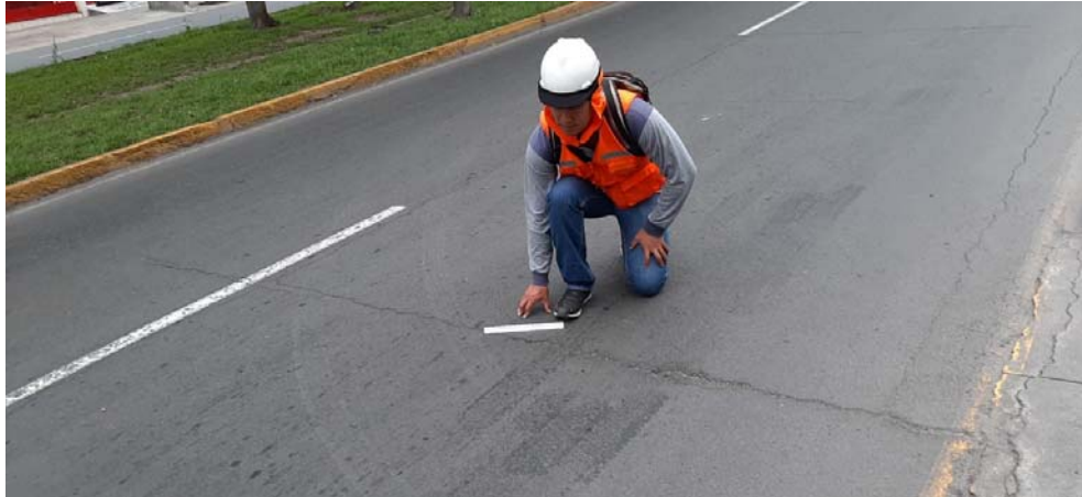
Figura 19. Grietas de reflexión de junta en avenida Los Constructores en La Molina, Lima - Perú.
