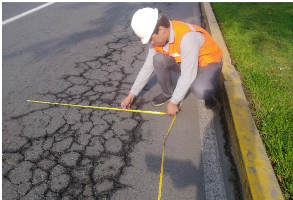
Figura 12. Piel de cocodrilo en avenida Los Constructores en La Molina, Lima - Perú.
