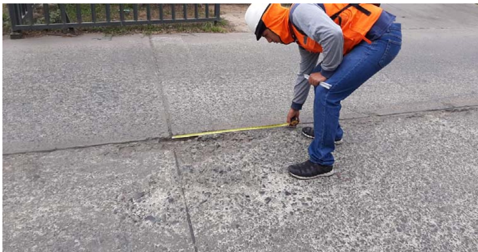
Figura 48. Descascaramiento de esquina en jirón Cueto Fernandini, La Molina - Perú.
