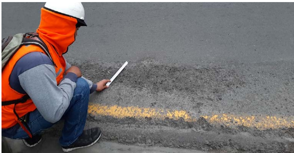
Figura 30. Desprendimiento de agregados en avenida Los Constructores en La Molina, Lima - Perú.
