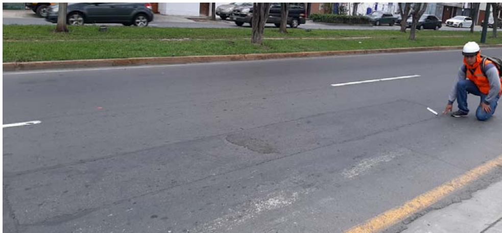
Figura 22. Parche y acometida de servicios públicos en avenida Los Constructores en La Molina, Lima - Perú.
