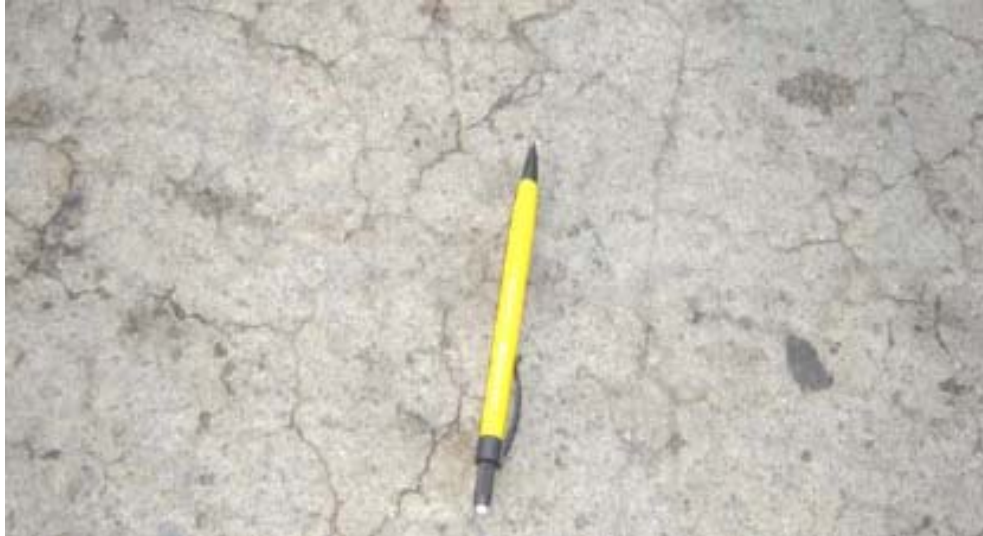
Figura 47. Grietas de retracción.
