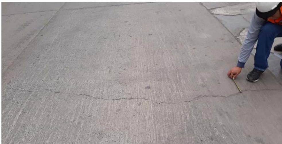
Figura 38. Grietas lineales en jirón Ricardo Palma, La Molina - Perú.
