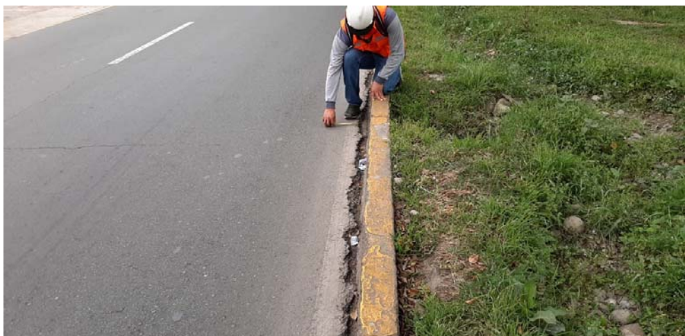
Figura 18. Grieta de borde en avenida Los Constructores en La Molina, Lima - Perú.
