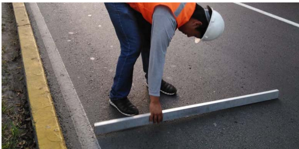
Figura 26. Ahuellamiento en avenida Los Constructores en La Molina, Lima - Perú.
