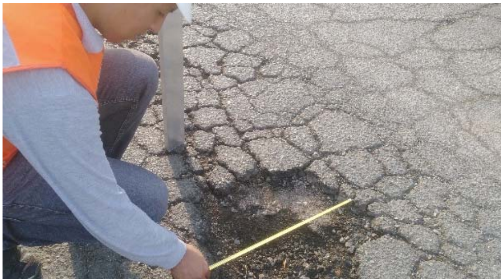
Figura 24. Huecos en avenida Los Constructores en La Molina, Lima - Perú.
