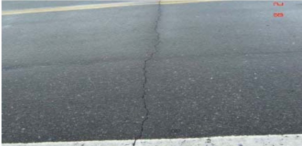
Figura 21. Grietas longitudinales y transversales.
