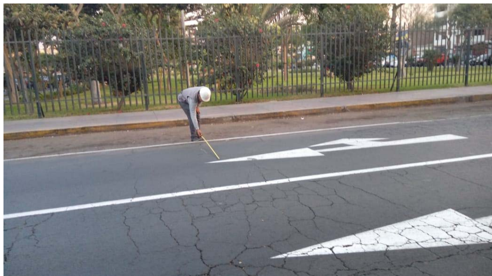
Figura 14. Agrietamiento en bloque en avenida Los Constructores en La Molina, Lima - Perú.
