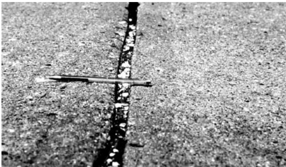
Figura 36. Deterioro en sello de junta.
