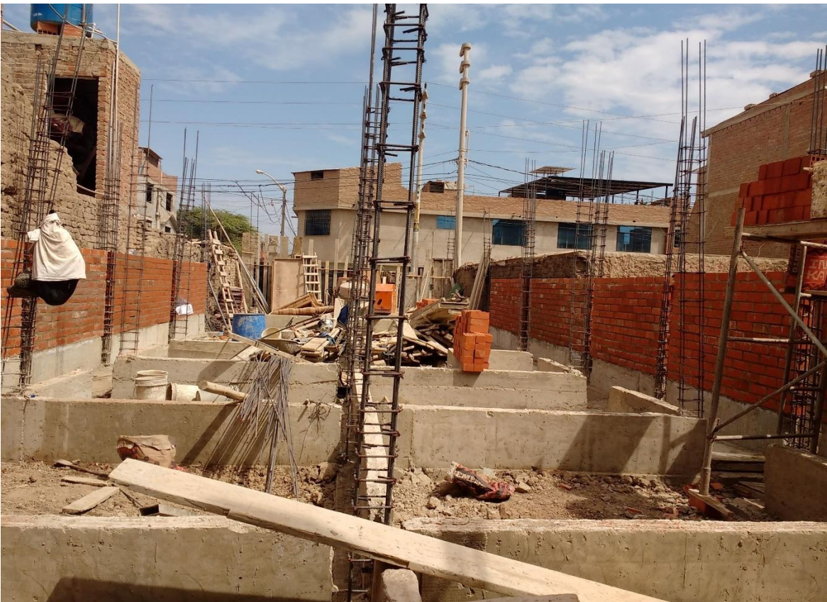
Descripción: Se observa el avance de asentado de ladrillo y llenado de sobrecimiento
