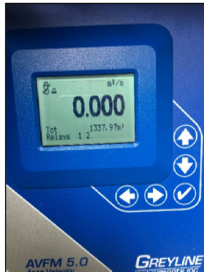
Figura 8: Caudalímetro AVFM 5.0. Elaboración: el autor
