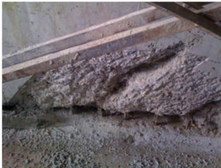
Figura 3. Deterioro de concreto por agentes externos
