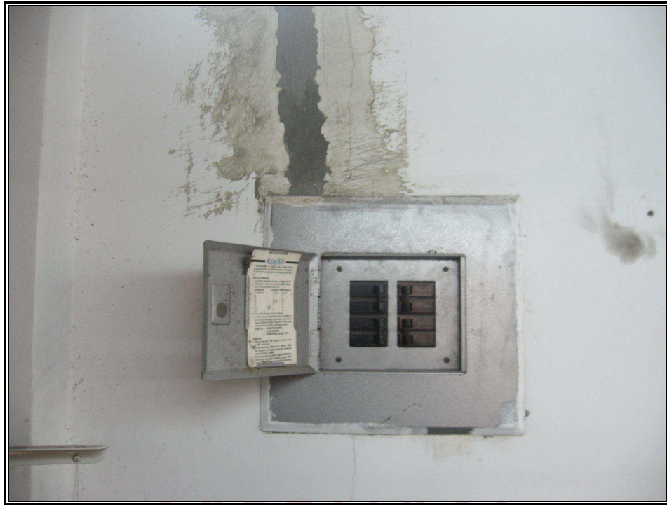
Foto 8: Falta de señalética de seguridad en sección de acabados Fuente: Captura propia
