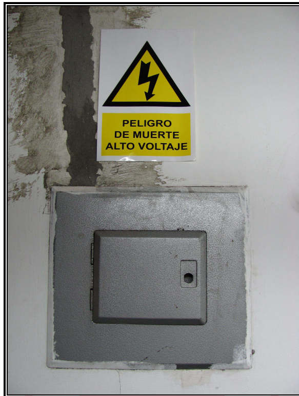
Foto 14: Señalización en zonas de peligro
