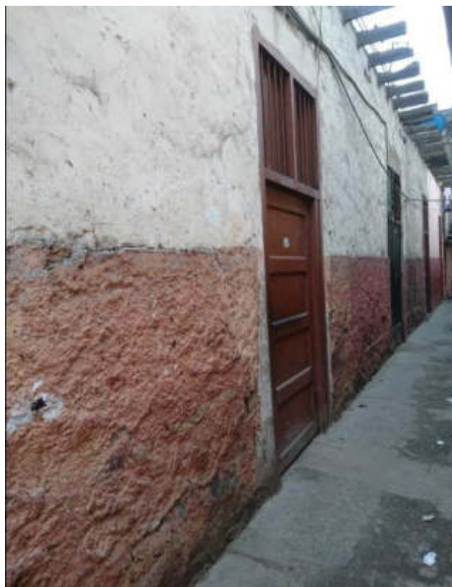
Figura 67. Grietas y fisuras en paredes de fachada
