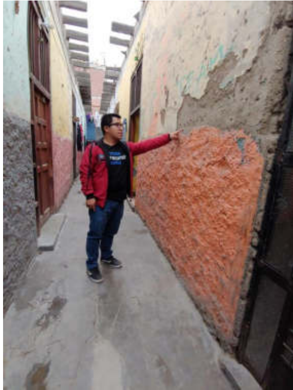
Figura 60. Mal estado de conservación
