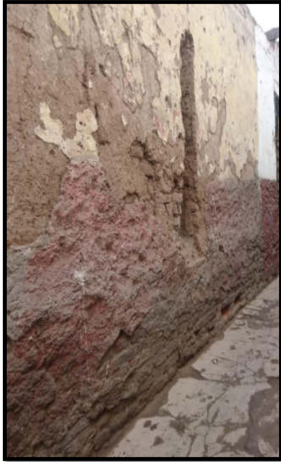
Figura 14. Edificación de adobe con mala calidad de material y espesores de las juntas no homogéneas
