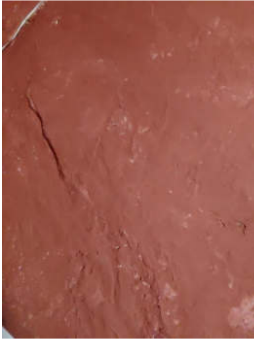
Figura 68. Grietas y fisuras en pared en el interior de la vivienda
