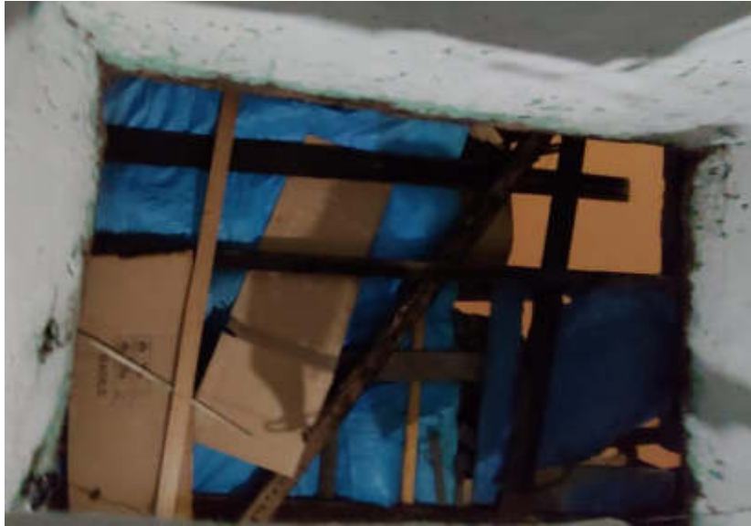
Figura 62. Cubierta en estado inestable
