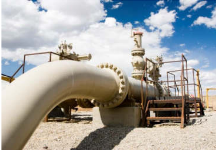
Figura 9: Válvulas de seccionamiento Fuente: Oil & Gas Magazine. (2017)
