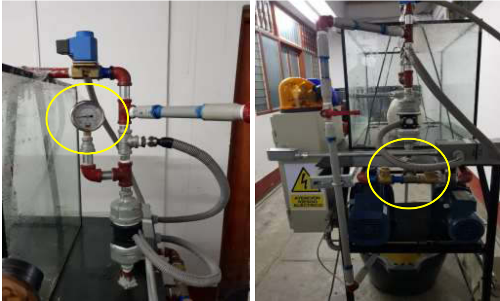
Figura 61. Manómetro hidráulico análogo y válvulas check.
