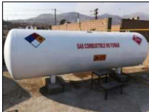
Figura 4. Tanque estacionario de GLP superficial.
