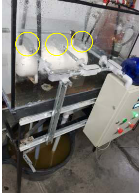
Figura 59. Instalación de 2 sensores de temperatura DS18B20.
