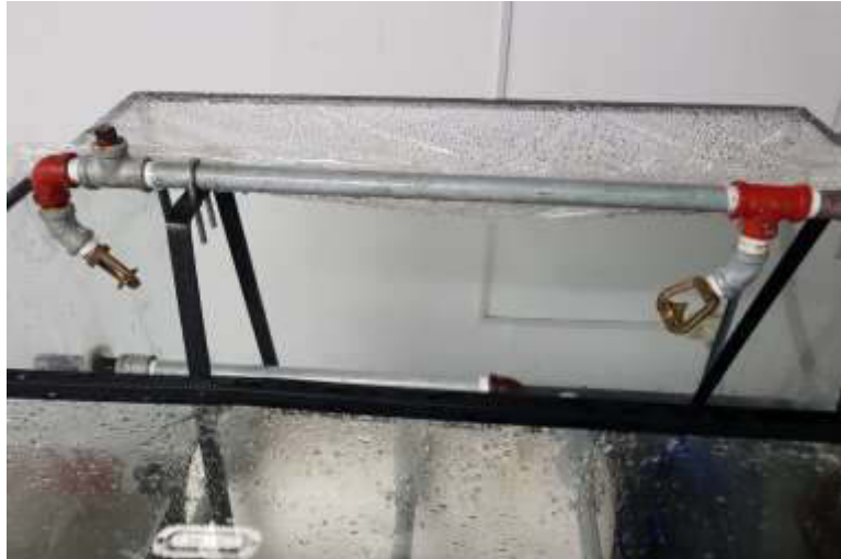
Figura 62. Aspersores para la descarga de agua.
