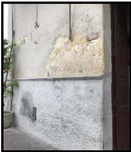
Figura 44. Visualizamos la humedad en los muros de la fachada.
