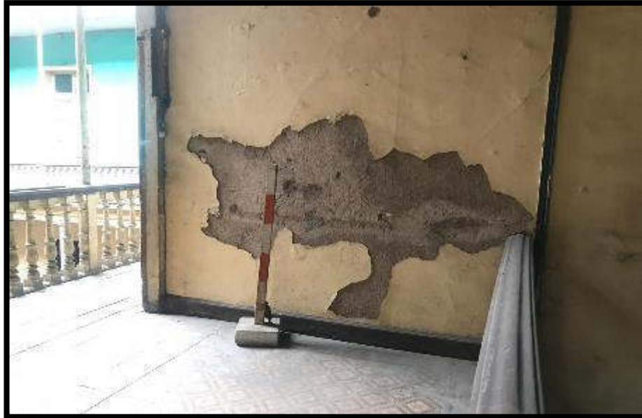
Figura 48. Desprendimiento del recubrimiento en el segundo nivel.
