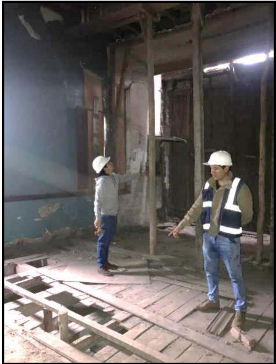
Figura 34. Visualiza el mal estado del entrepiso.
