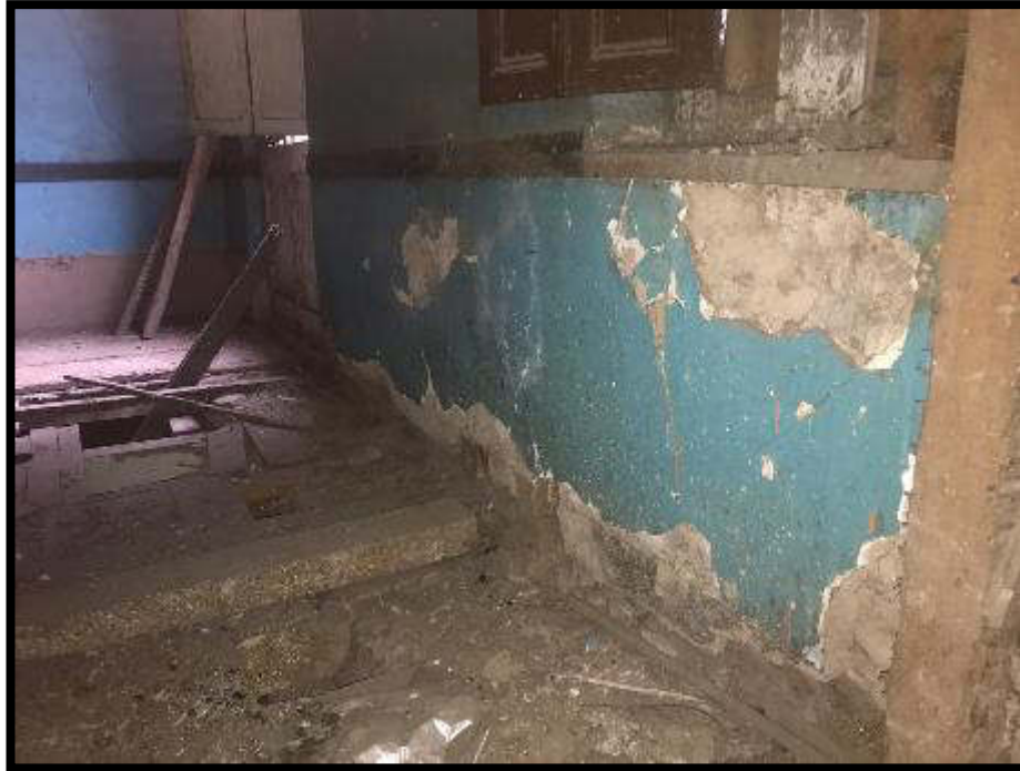
Figura 46. Desprendimiento del material de recubrimiento.
