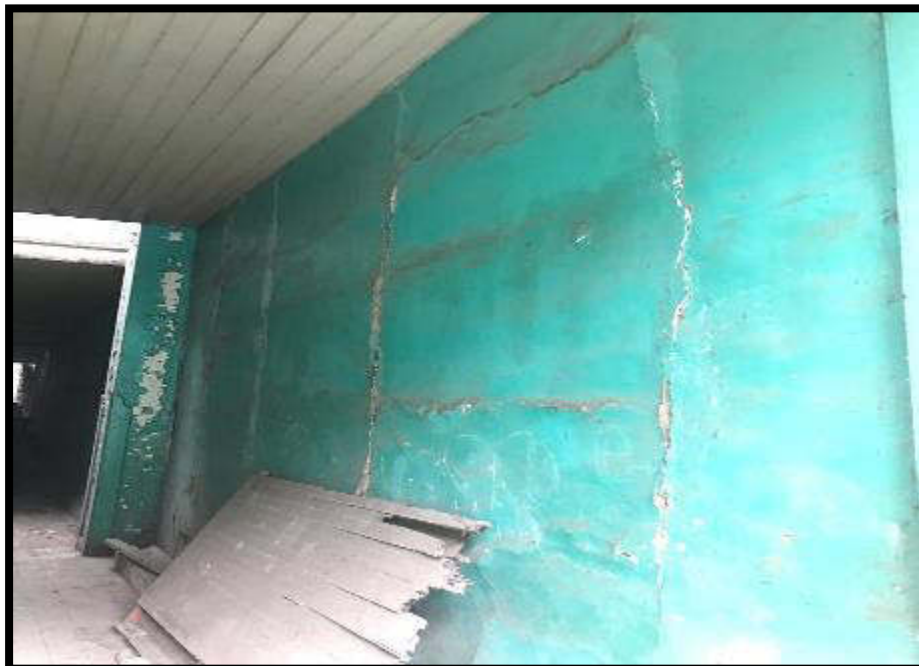
Figura 45. Grietas en muros del segundo nivel.
