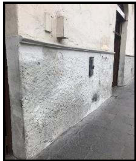
Figura 43. Fallas por humedad.
