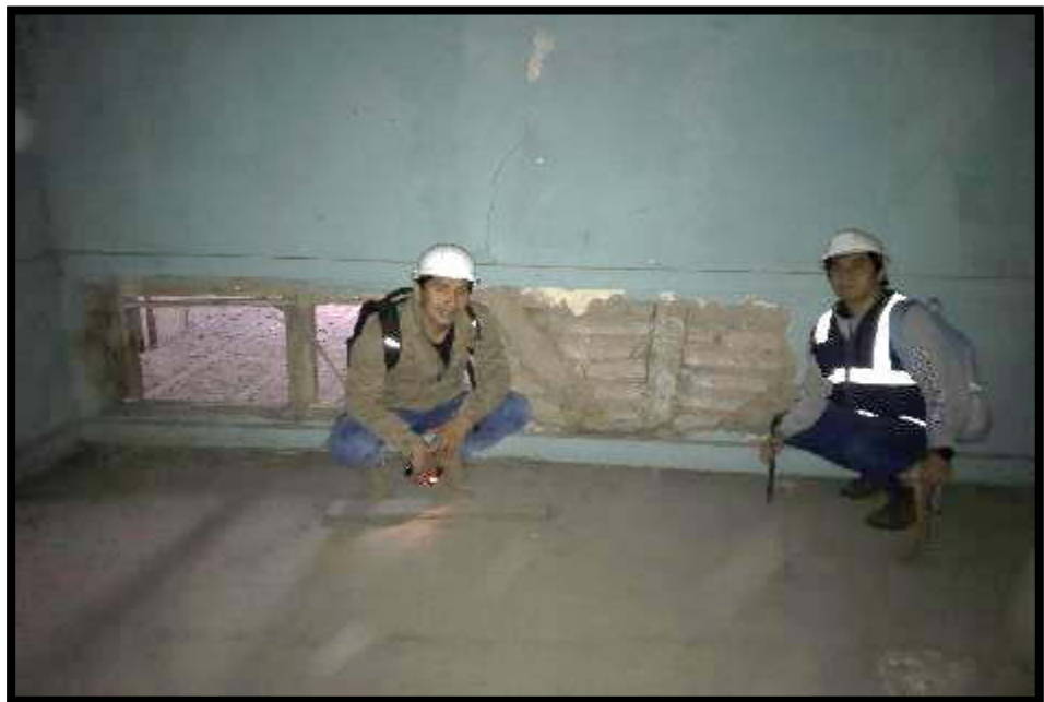
Figura 41. Muros de quincha deteriorados.
