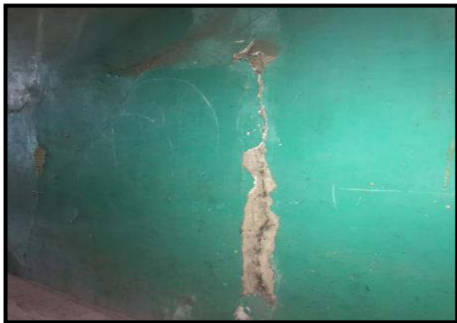
Figura 47. Visualiza las fisuras en los muros.
