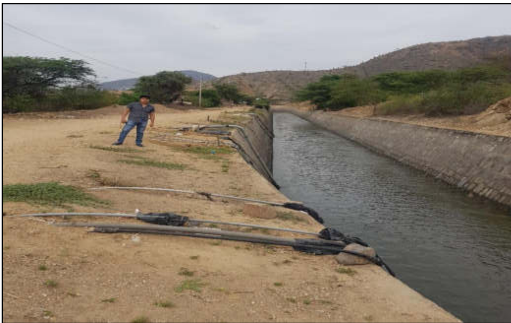
FOTOGRAFÍA N° 02: Canal del sistema de agua potable evidenciando la contaminación y las sustracciones ilegales mediante tuberías de diversas pulgadas por parte de los habitantes del distrito de Chongoyape.
