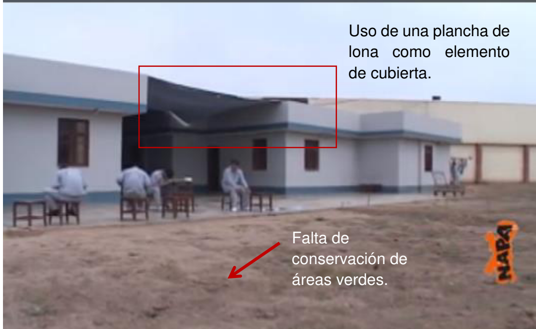
Figura 16. Estructuras precarias o en mal estado Fuente: Captura de pantalla video 'Maranguita desde dentro'
