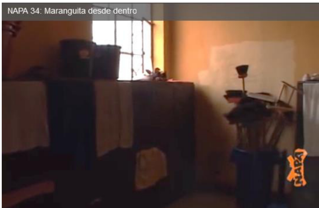
Figura 11. Falta de espacio de almacenamiento de útiles de aseo Fuente: Captura de pantalla video 'Maranguita desde dentro'
