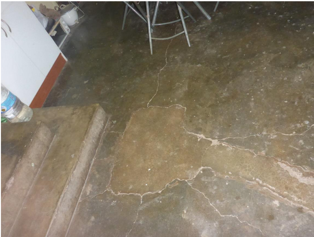
Foto N°18 viviendas con acabado de falso piso en mal estado
