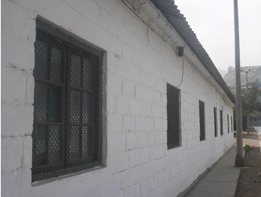
Foto N.º 9 Ventanas antiguas sin ventilación
