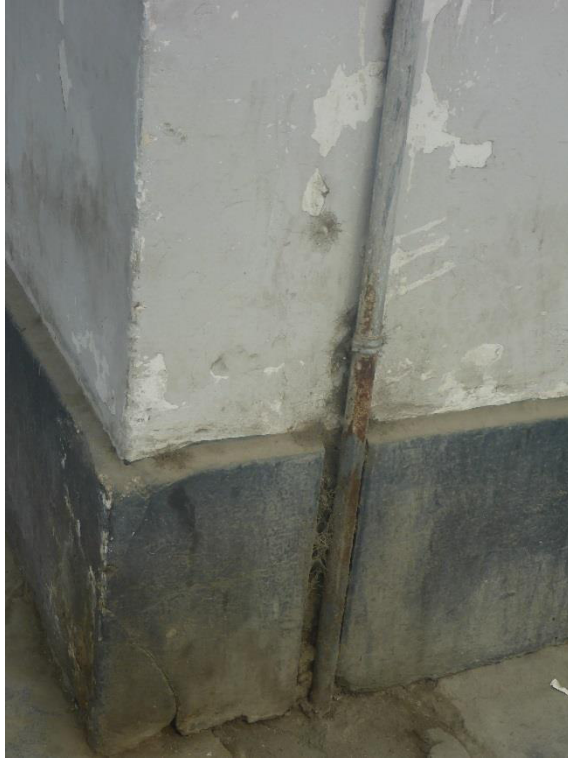
Foto N°15 Tuberías expuestas y oxidadas.
