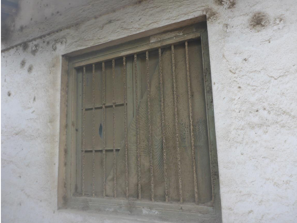
Foto N°17 Ventanas y marco oxidados
