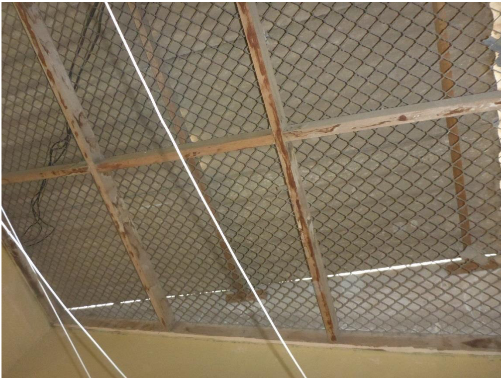
Foto N°20 Techo asbesto sin ninguna protección al interior de la vivienda.
