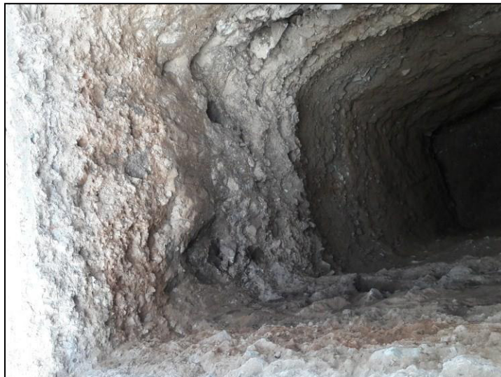
SE NOTA EN LA PARED DE LA CALICATA LAS MUESTRAS DESCRITAS DE GRAVAS EMPACADAS CON MATERIAL GRANULAR FINO Y LIMOS.
