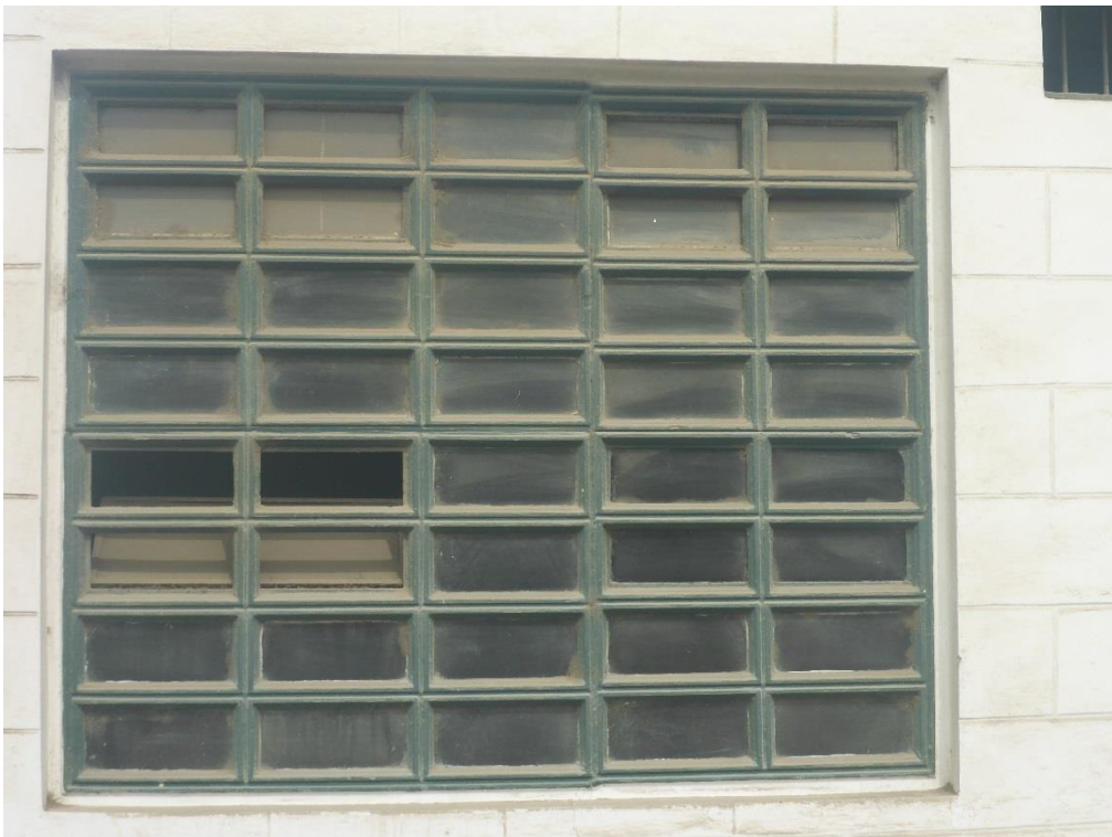
Foto N°14 Ventanas antiguas sin mucha ventilación a la vivienda.
