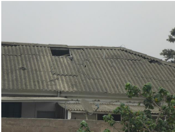
Figura N ° 3 Cobertura del asbesto en mal estado.
