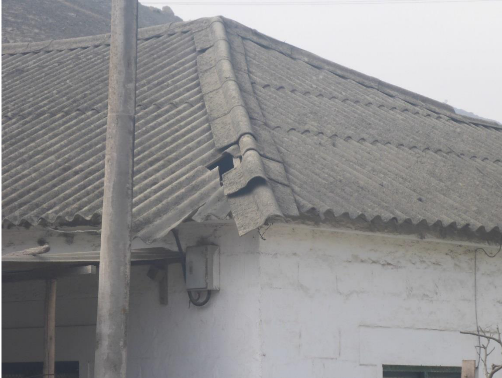
Foto N.º5 Techos de asbesto en mal estado
