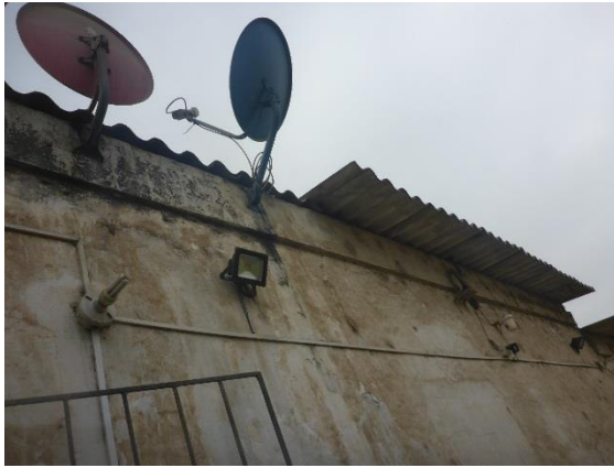
Figura N ° 1 Muros en mal estado.
