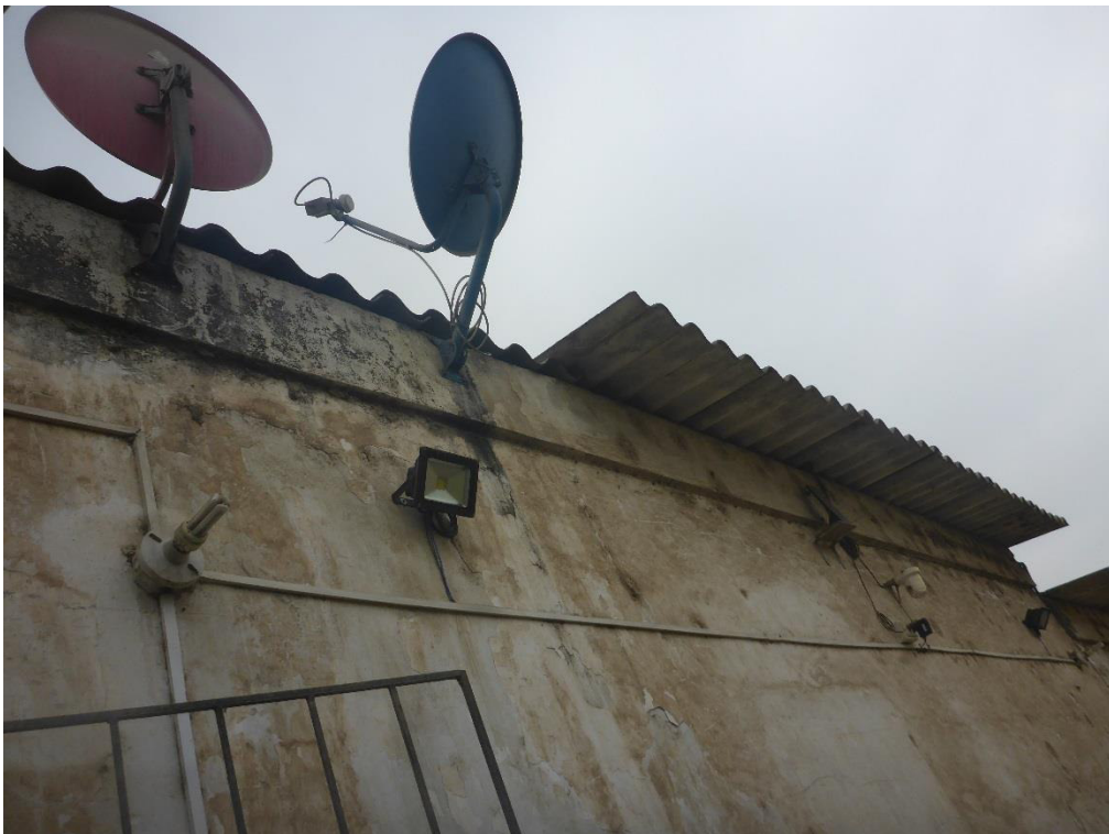
Foto N.º4 Muro deteriorada con instalaciones expuestas
