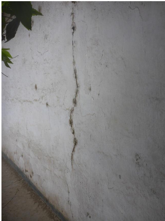
Foto N°16 Muro con fisuras de segundo grado
