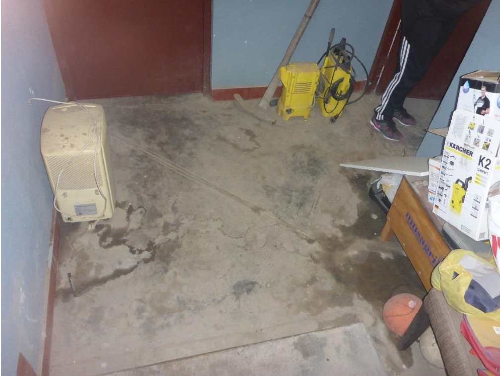
Foto N°19 Pisos húmedos de viviendas
