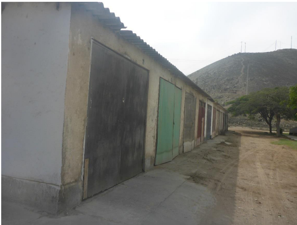
Foto N.º1 Vista de módulos de vivienda con puertas en mal estado
