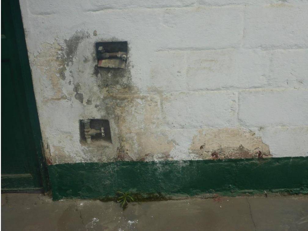
Foto N°11 Muros con exposición al agua
