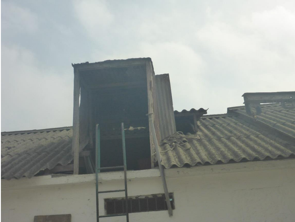
Foto N.º 7 Aberturas de techos sin protección al interior
