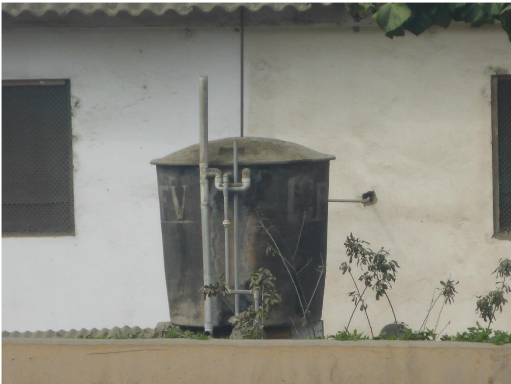
Foto N°22 Tanques antiguos de acero que usan hoy en día las viviendas.
