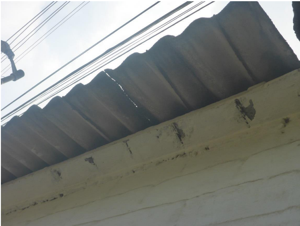
Foto N.º 10 Deterioro de base de techo, viéndose el oxidado
