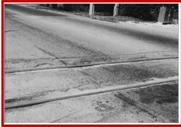
Figura 42: Cruce de vía férrea - severidad media
