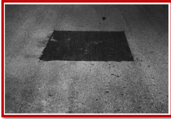
Figura 34: Parcheo y acometidas de servicios públicos - severidad baja
