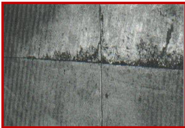
Figura 97: Descascaramiento de junta - severidad media
