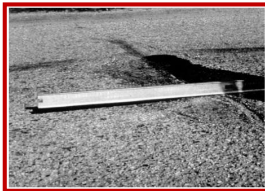
Figura 13: Abultamiento y hundimientos - severidad baja
