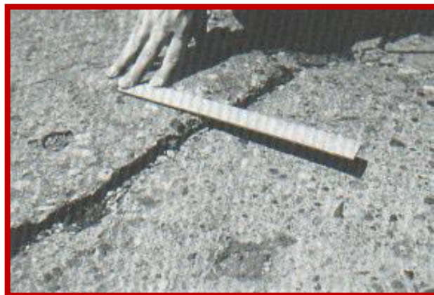
Figura 70: Falla de escala - severidad media
