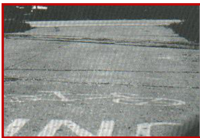
Figura 91: Cruce de vía férrea - severidad media
