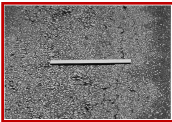
Figura 54: Meteorización y desprendimiento de agregados - severidad baja
