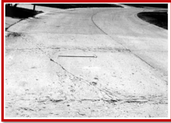
Figura 68: Grieta de durabilidad - severidad alta
