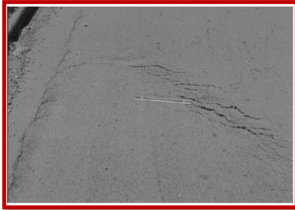
Figura 51: Grietas parabólicas - severidad media
