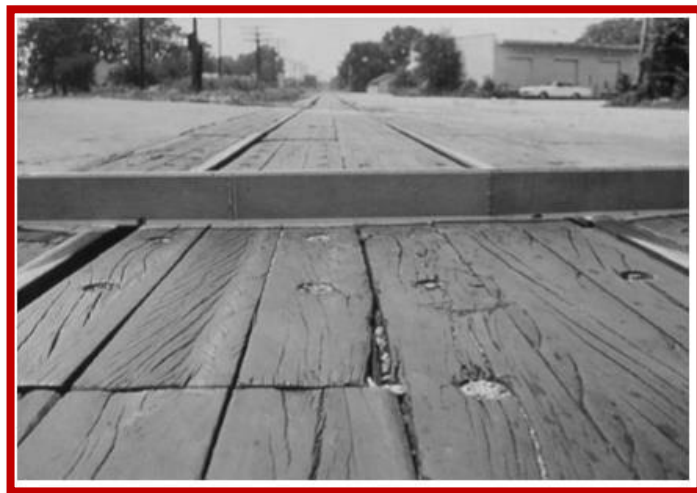
Figura 41: Cruce de vía férrea - severidad baja
