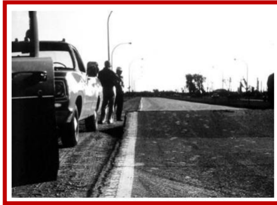
Figura 59: Blowup - Buckling - severidad alta
