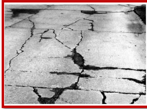
Figura 65: Losa dividida - severidad alta
