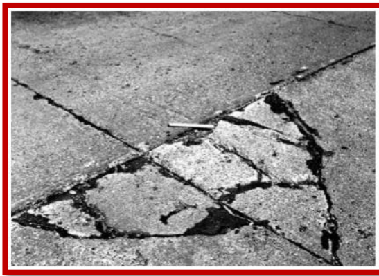
Figura 62: Grieta de esquina - severidad alta
