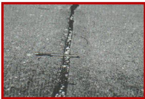
Figura 74: Sello de junta - severidad alta
