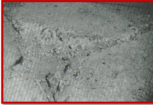
Figura 95: Descascaramiento de esquina - severidad alta
