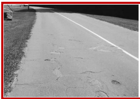
Figura 56: Meteorización y desprendimiento de agregados - severidad alta
