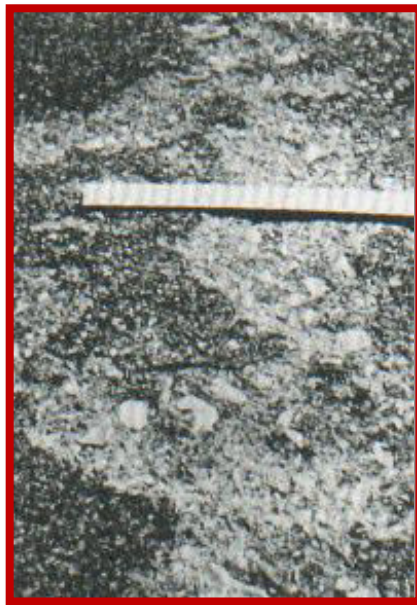
Figura 92: Desconchamiento/Mapa de grietas/Craquelado - severidad media
