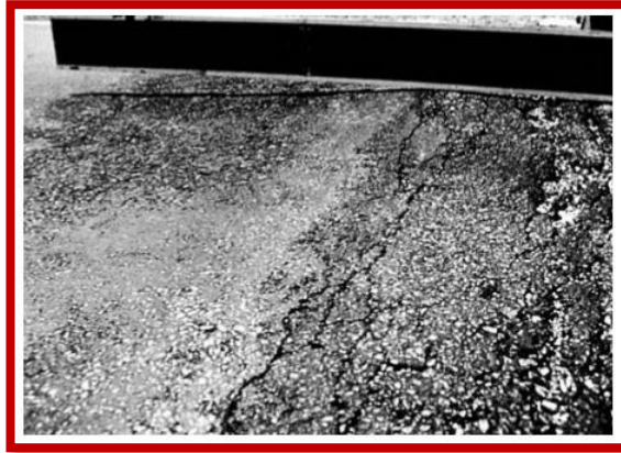
Figura 15: Abultamientos y hundimientos - severidad alta
