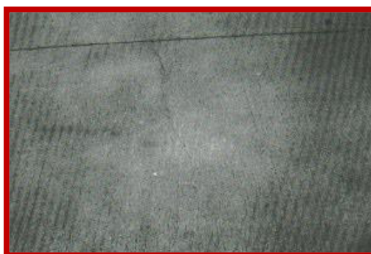
Figura 94: Grietas de retracción
