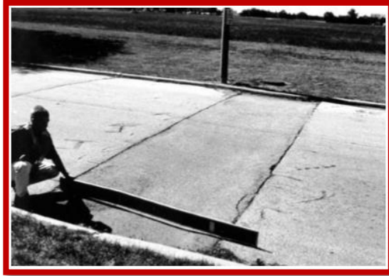
Figura 35: Parcheo y acometidas de servicios públicos - severidad media
