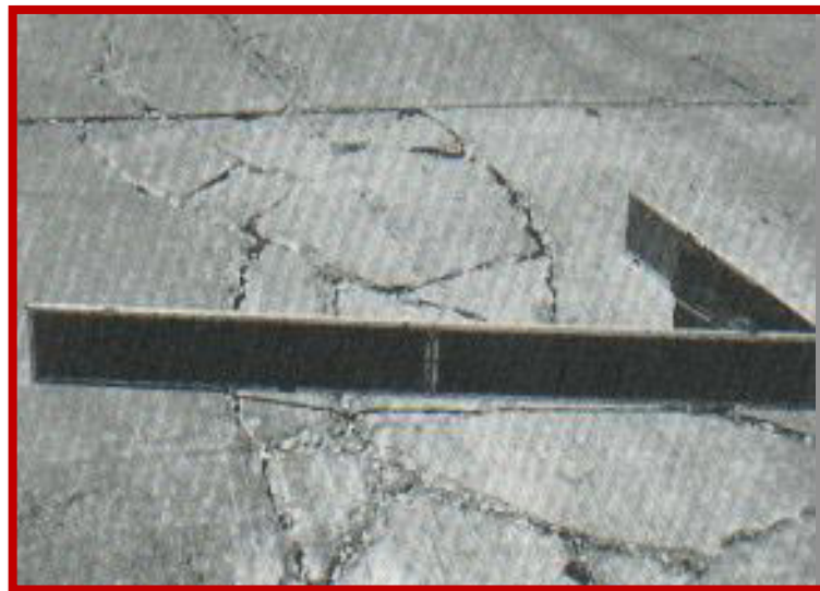
Figura 90: Punzonamiento - severidad alta
