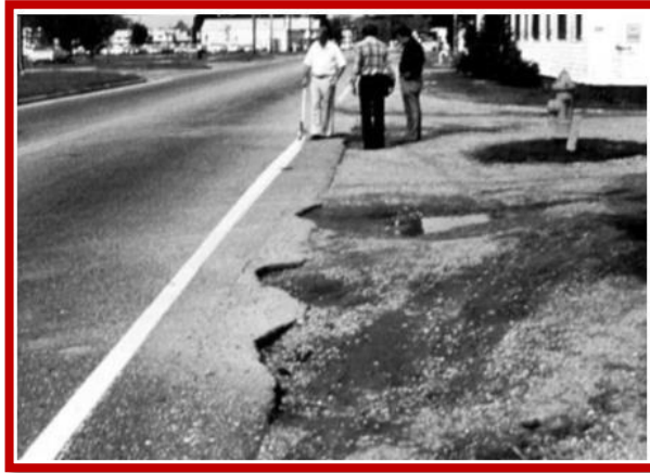
Figura 24: Grieta de borde - severidad alta
