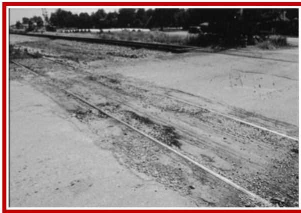
Figura 43: Cruce de vía férrea - severidad alta
