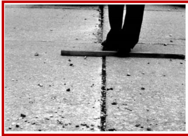
Figura 69: Falla de escala - severidad baja
