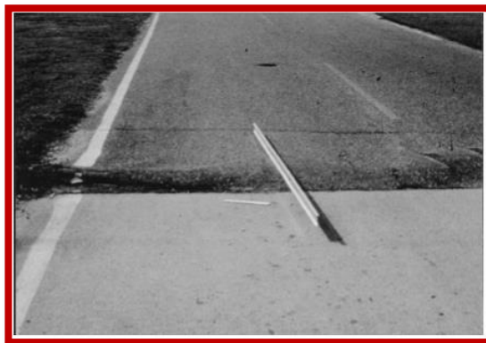
Figura 49: Desplazamiento - severidad alta
