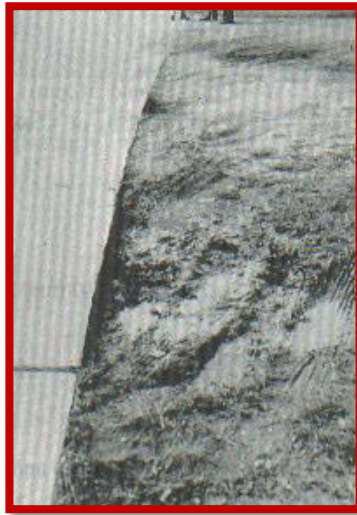
Figura 76: Desnivel carril/berma - severidad media
