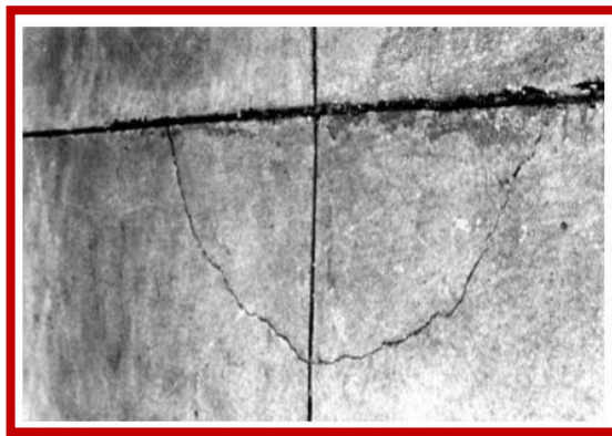
Figura 60: Grieta de esquina - severidad baja
