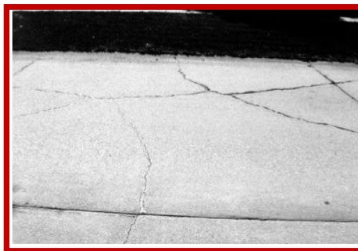
Figura 64: Losa dividida - severidad media
