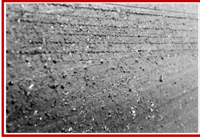
Figura 9: Exudación - severidad alta
