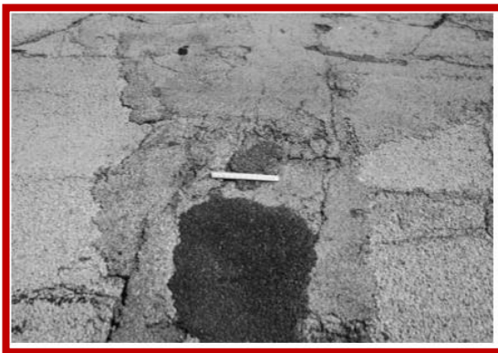
Figura 36: Parcheo y acometidas de servicios públicos - severidad alta
