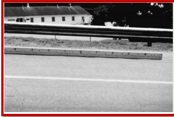
Figura 16: Corrugación - severidad baja
