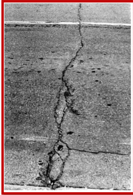
Figura 26: Grieta de reflexión de junta - severidad media
