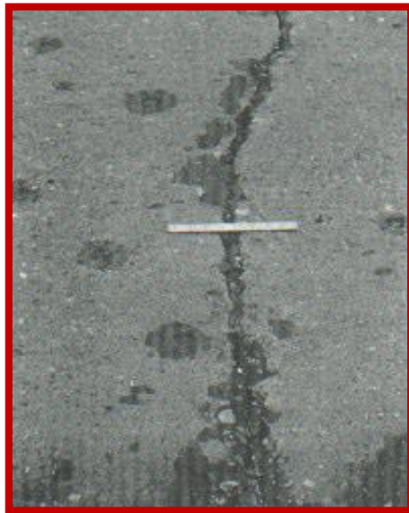
Figura 79: Grietas lineales - severidad media
