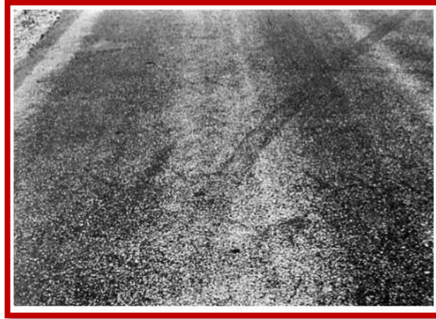
Figura 7: Exudación - severidad baja
