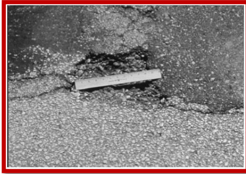
Figura 38: Huecos - severidad baja
