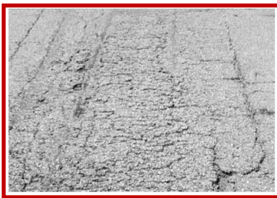
Figura 55: Meteorización y desprendimiento de agregados - severidad media
