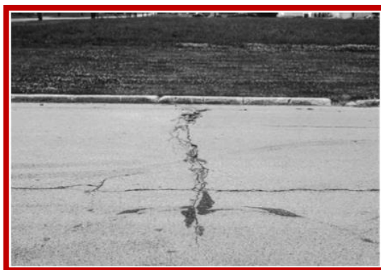
Figura 33: Grietas longitudinales y transversales - severidad alta
