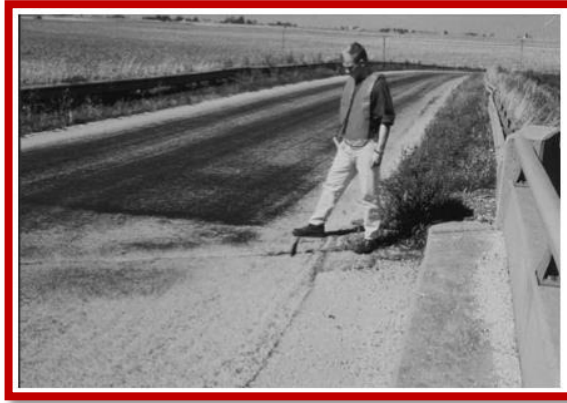
Figura 47: Desplazamiento - severidad baja
