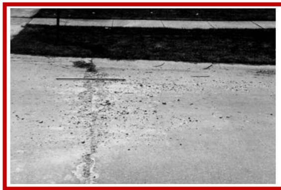
Figura 57: Blowup - Buckling - severidad baja
