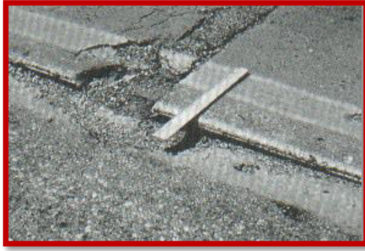
Figura 75: Desnivel carril/berma - severidad baja
