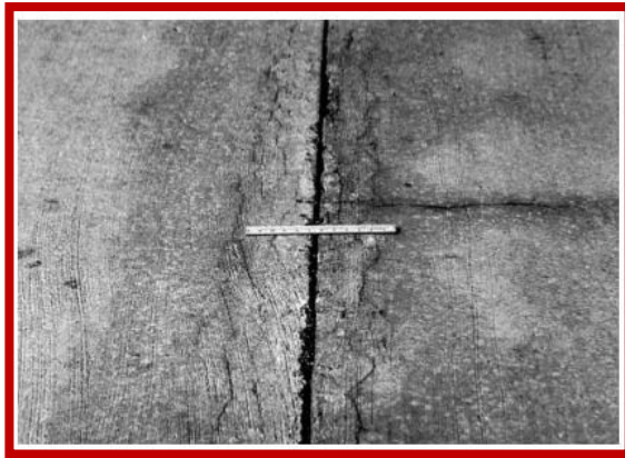
Figura 66: Grieta de durabilidad - severidad baja
