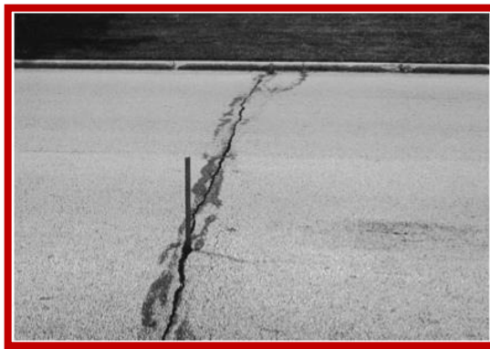
Figura 32: Grietas longitudinales y transversales - severidad media
