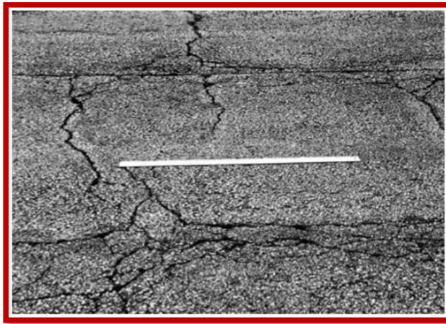
Figura 10: Agrietamiento en bloque - severidad baja
