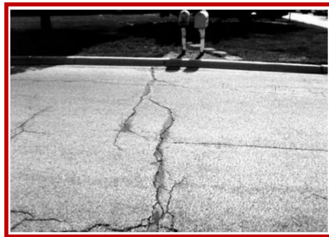
Figura 11: Agrietamiento en bloque - severidad media
