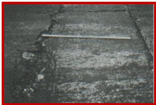
Figura 83: Parche grande - severidad alta
