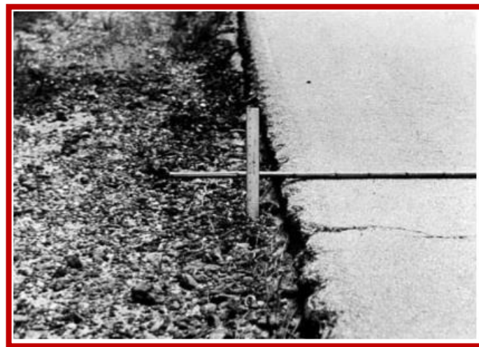
Figura 30: Desnivel carril/berma - severidad alta
