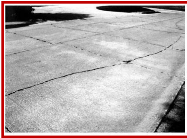
Figura 63: Losa dividida - severidad baja
