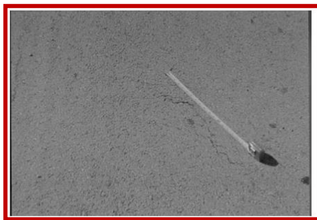
Figura 50: Grietas parabólicas - severidad baja
