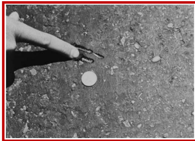
Figura 8: Exudación - severidad media
