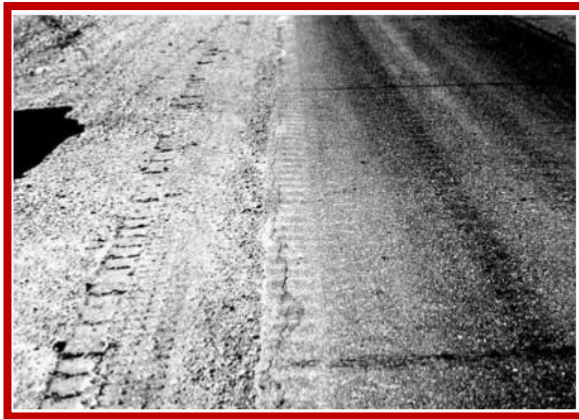
Figura 25: Grieta de reflexión de junta - severidad baja
