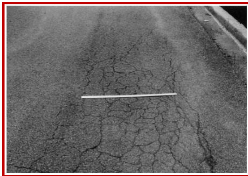
Figura 5: Piel de cocodrilo - severidad media
