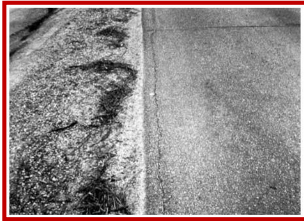
Figura 22: Grieta de borde - severidad baja
