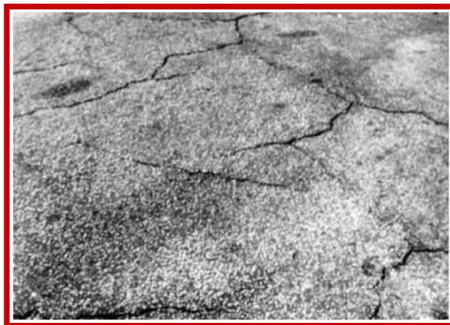
Figura 12: Agrietamiento en bloque - severidad alta
