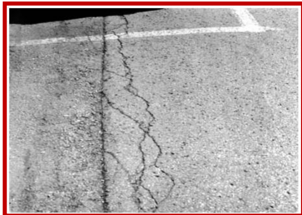
Figura 23: Grieta de borde - severidad media
