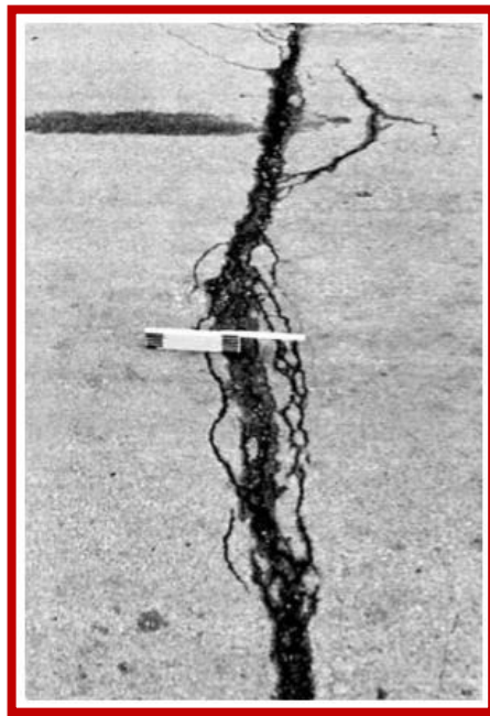
Figura 27: Grieta de reflexión de junta - severidad alta
