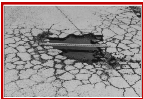
Figura 40: huecos - severidad alta
