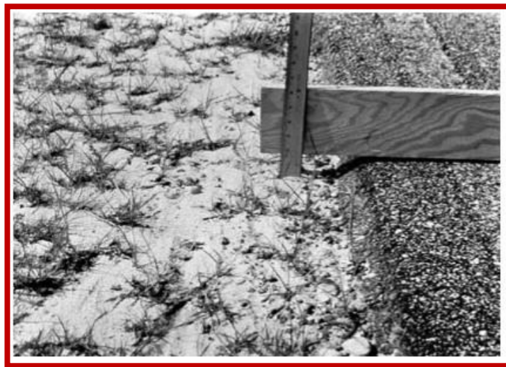
Figura 28: Desnivel carril/berma - severidad baja
