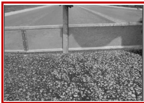
Figura 45: Ahuellamiento - severidad media
