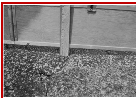
Figura 46: Ahuellamiento - severidad alta
