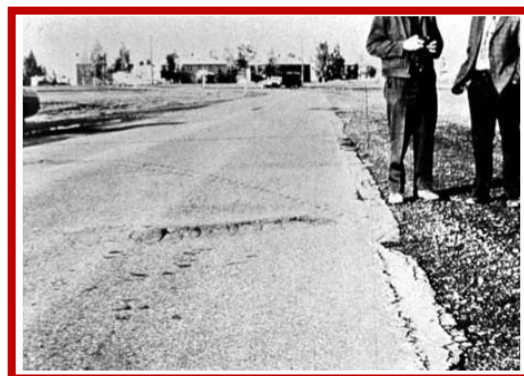
Figura 14: Abultamientos y hundimientos - severidad media
