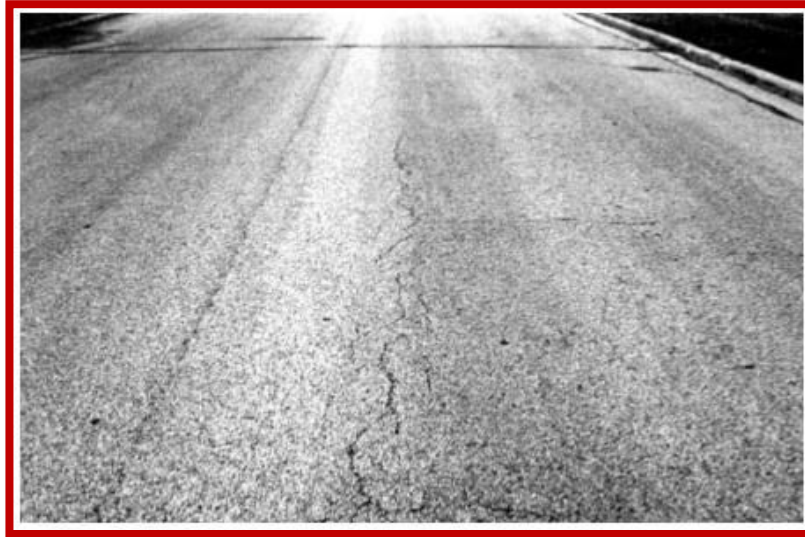
Figura 4: Piel de cocodrilo - severidad baja
