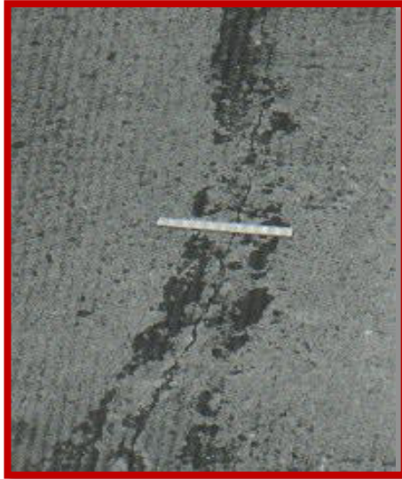
Figura 78: Grietas lineales - severidad baja
