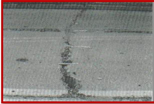
Figura 80: Grietas lineales - severidad alta
