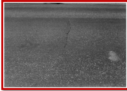
Figura 31: Grietas longitudinales y transversales - severidad baja
