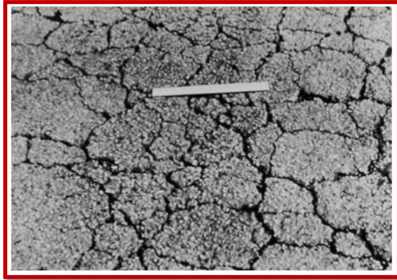
Figura 6: Piel de cocodrilo - severidad alta
