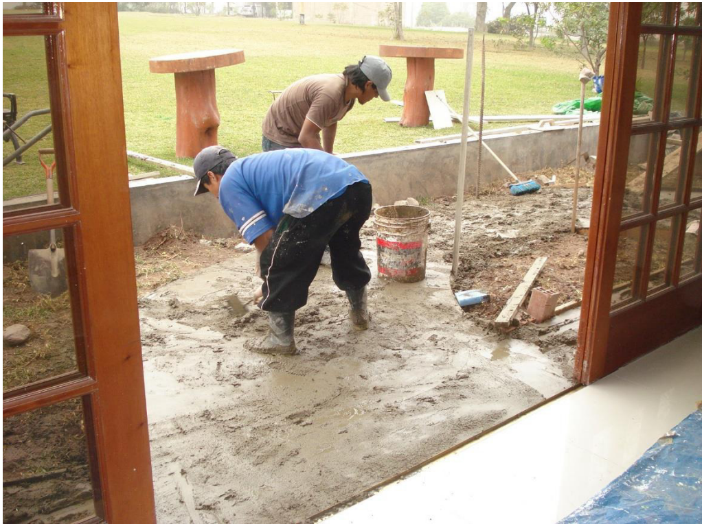
FIGURA 32. CONSTRUCCIÓN DE OBRA CIVIL SIN 5 S
