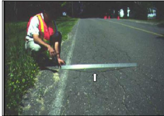
Figura 8. Depresión del pavimento (Fuente: Rodriguez, 2009)
