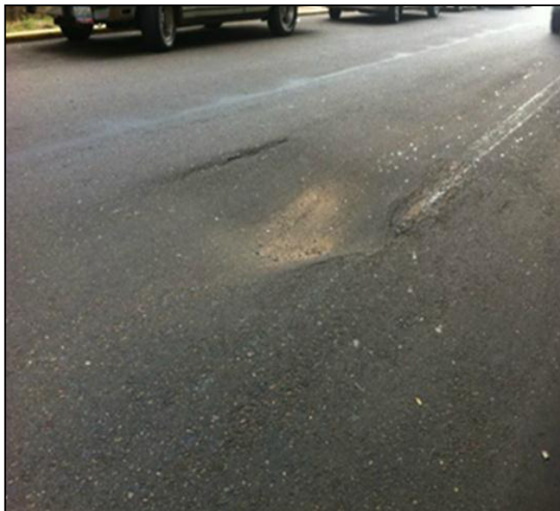
Figura 6. Deformación por hundimiento (Fuente: Elaboración Propia)
