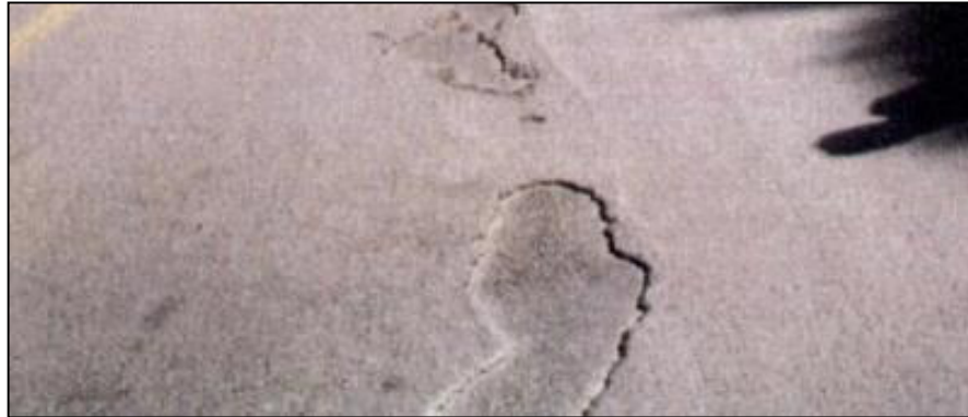
Figura 21. Desprendimiento superficial (Fuente: Ministerio de Transportes y Comunicaciones, 2014)
