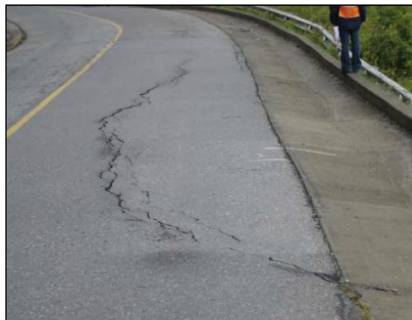
Figura 19. Fisura Parabólica (Fuente: Ministerio de Transporte Instituto Nacional de Vías, 2006)
