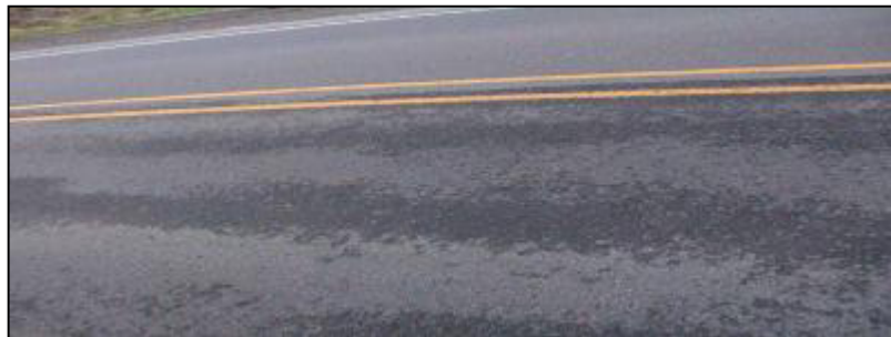
Figura 4. Exudación asfáltica (Fuente: Elaboración Propia)
