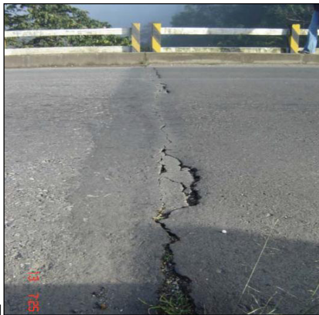
Figura 10. Fisura de reflexión (Fuente: Instituto Nacional de Vías, 2006)
