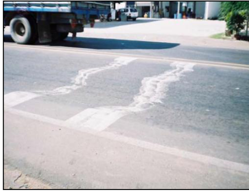
Figura 17. Ahuellamiento (Fuente: Ministerio de Transporte Instituto Nacional de Vías, 2006)
