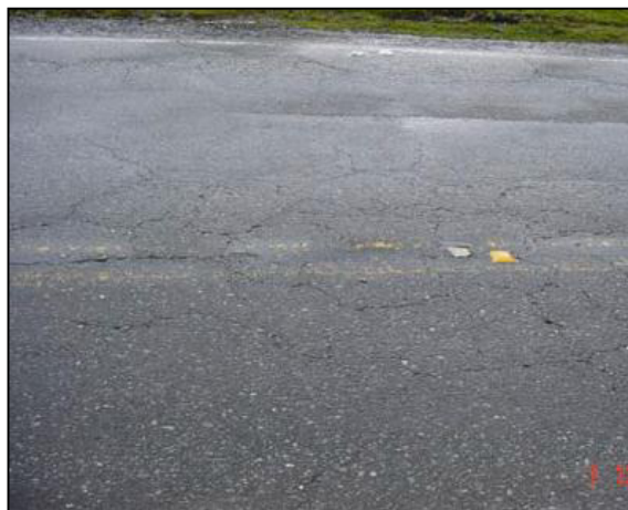
Figura 5. Fisuras en Bloque (Fuente: Manual para la Inspección Visual de Pavimentos Flexibles, Colombia)
