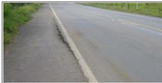
Figura 18. Desplazamiento del Asfalto (Fuente: Ministerio de Transporte Instituto Nacional de Vías, 2006)
