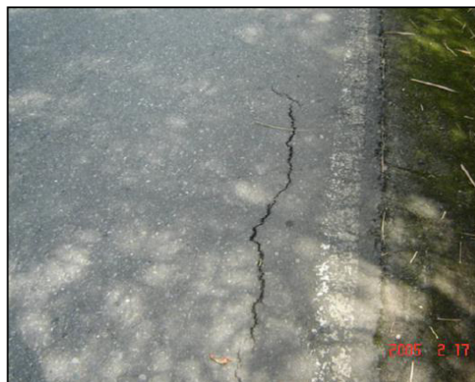
Figura 9. Fisura de borde (Fuente: Recuperado de http://hechosdetransito.com/danos-en-las-vias/ )
