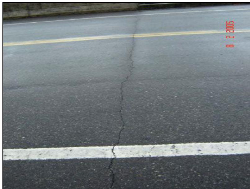
Figura 13. Fisura transversal (Fuente: Instituto Nacional de Vías, 2006)
