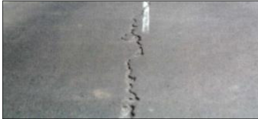
Figura 12. Fisura longitudinal (Fuente: Ministerio de Transportes y Comunicaciones, 2014)
