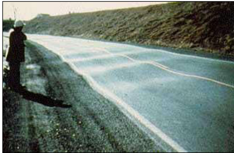
Figura 20. Hinchamiento por congelamiento (Fuente: Recuperado de http://fletch3hr.blogspot.pe/2013/04/deterioro-de-pavimentos.html )
