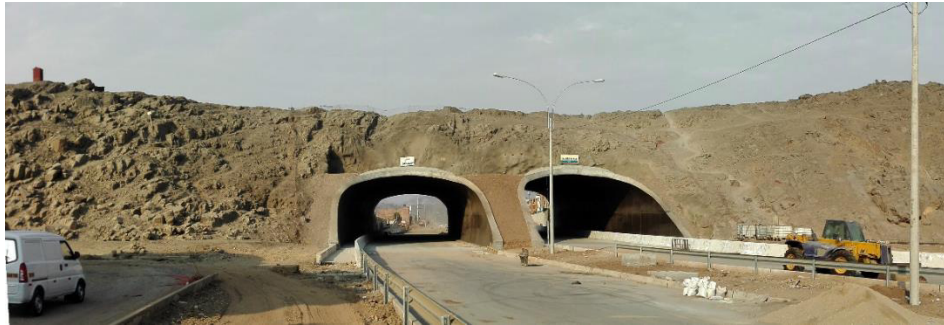
Imagen: Avance de las obras del túnel del cerro Puruchuco. Fuente: elaboración propia, Lima 2016
