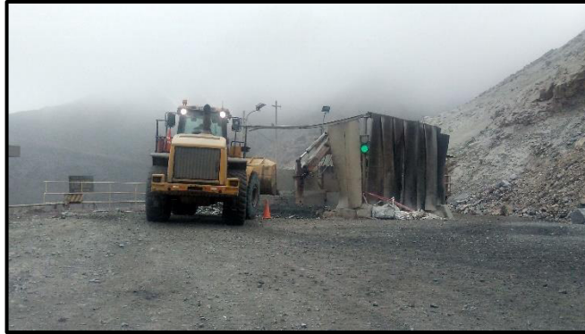
Figura 13. Zona de Abastecimiento de Mineral Chancado Primario – Rompe Bancos
