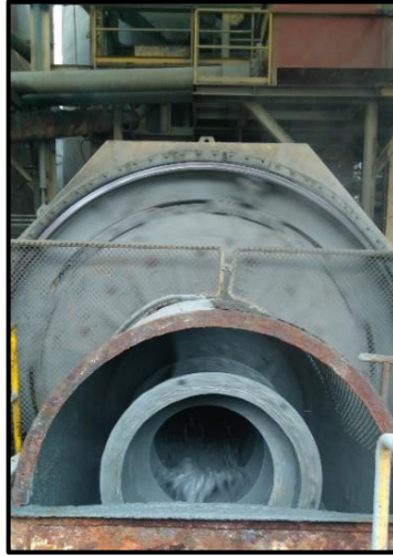
Figura 20. Interior del Molino N° 3 – Alimentación de Agua
