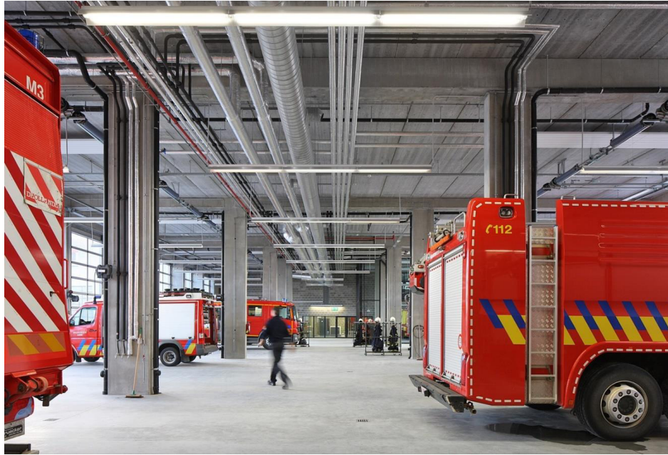
Figura 58. Sala de máquinas Archdaily Perú, 2016
