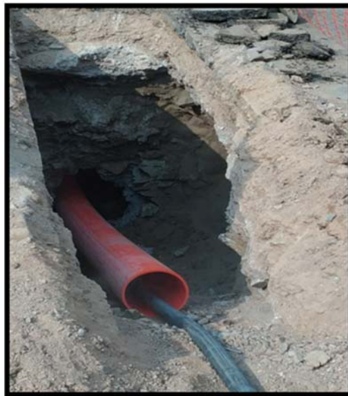
Figura 30: Ingreso de la tubería de HDPE de 8" en una de las ventanas
