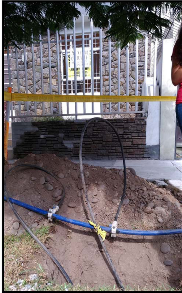
Figura 17. Sistema provisional de agua
