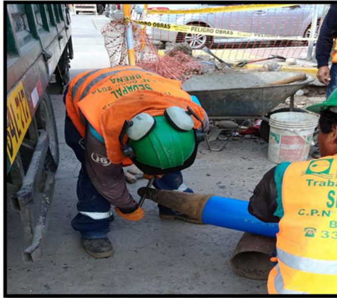
Figura 20. Instalación del cabezal de rotura en el otro extremo del cambio de tubería
