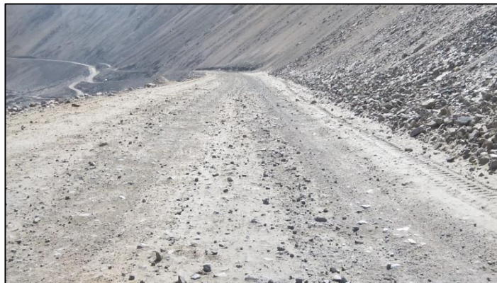
Figura 63: Sector de caída de piedras
