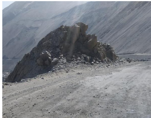
Foto N° 30 Km 29+000 Se puede observar el mal estado de la superficie de rodadura en ese sector puntual.
