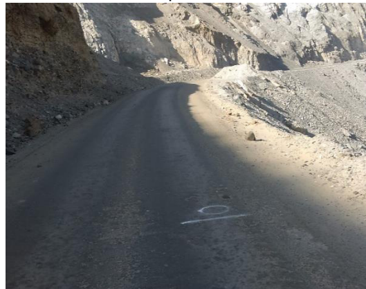
Foto N° 24 Km 26+000 Se observa la buena condición de la superficie de rodadura en ese sector.
