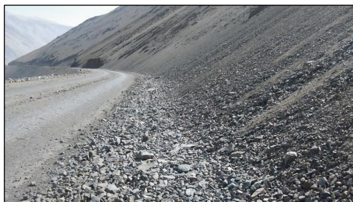
Figura 64: Sector de caída de piedras
