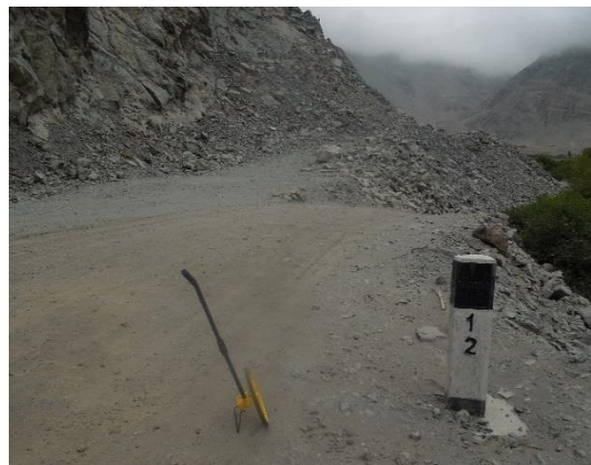
Foto N° 10 Km 12+000 Se aprecia sector de cantera en esa progresiva, con plataforma en mal estado.
