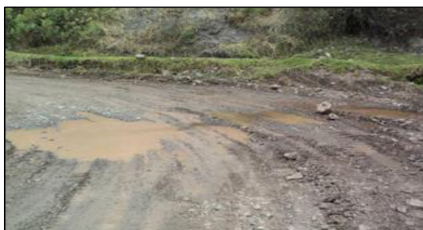
Figura 9: Ejemplo de sección transversal inapropiada
