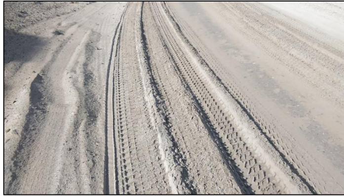
Figura 62: Sector con acumulación de arena
