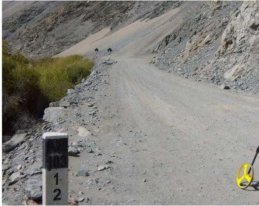
Foto N° 13 Km 12+000 Se puede observar la superficie de rodadura, en mal estado en ese sector.
