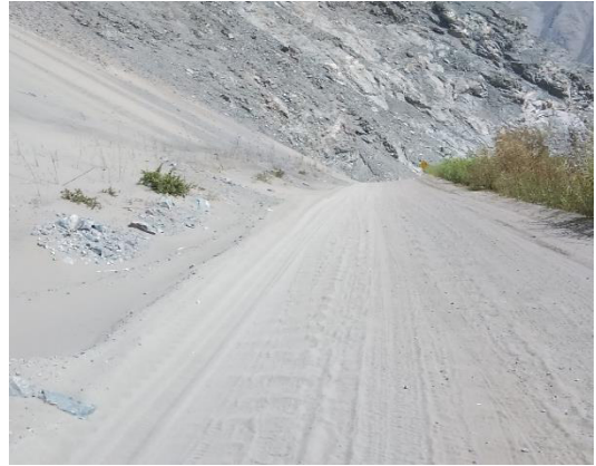
Foto N° 14 Km 12+200 Se aprecia la condición de la superficie de rodadura en ese sector con arenamiento.
