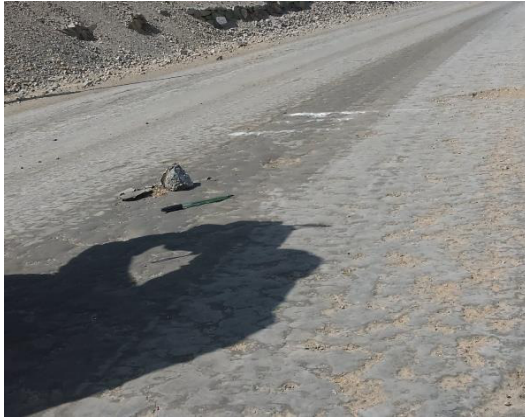
Foto N° 37 Km 32+400 Se aprecia la superficie de rodadura con caída de piedras y el daño que causa.
