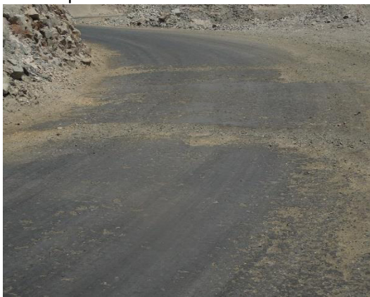
Foto N° 21 Km 25+200 Se observa sector en curva con fallas frecuentes en que se dan en la plataforma en curvas.
