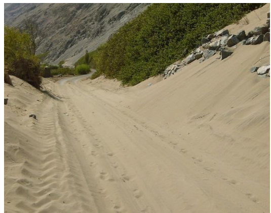
Foto N° 16 Km 13+000 Se puede apreciar las condiciones de arenamiento de la plataforma en ese sector de la vía.
