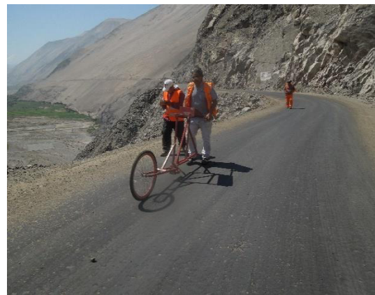
Foto N° 40 Km 25+000 Se aprecia los trabajos de medición de la rugosidad de la superficie de rodadura.
