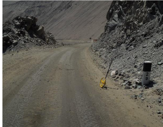
Foto N° 26 Km 29+000 Se aprecia las fallas en curva en esa parte de la vía.
