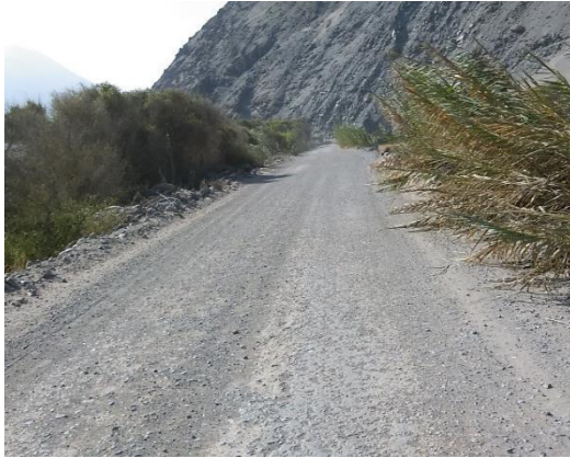
Foto N° 07 Km 08+500 Se puede observar la condición de la superficie de rodadura, en regular estado.
