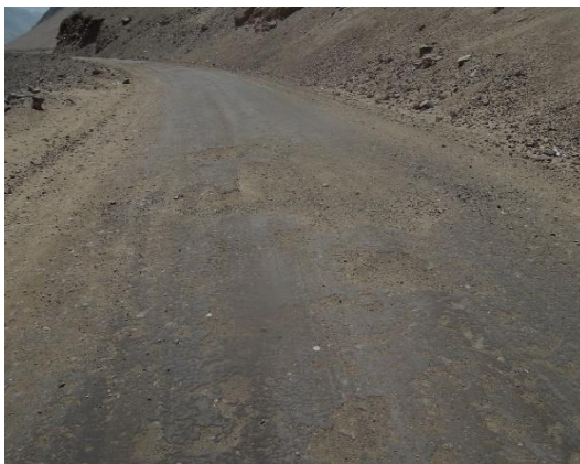
Foto N° 23 Km 26+280 Se aprecia parte de la plataforma con fallas por caída de piedras, sector en curva.
