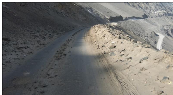
Figura 61: Sector de ca6da de piedras
