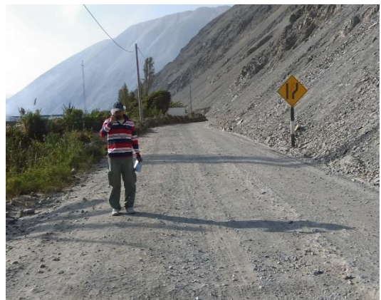
Foto N° 18 Km 14+000 Se aprecia sector de la superficie de rodadura en regular estado.
