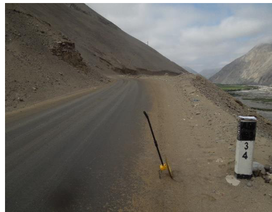
Foto N° 34 Km 34+000 Se puede observar el buen estado de la superficie de rodadura en ese sector.
