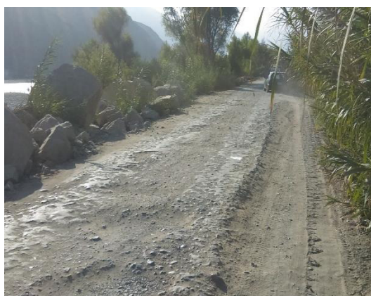
Foto N° 03 Km 05+500 Se observa la plataforma en mal estado, por trabajos de enrocado que han deteriorado la superficie de rodadura.
