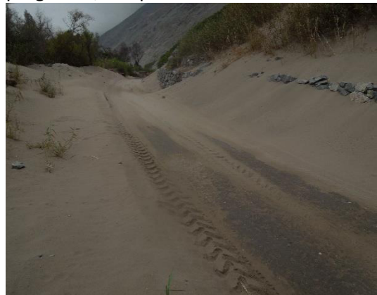
Foto N° 12 Km 13+000 Se aprecia sector de arenamiento de la plataforma en ese sector.
