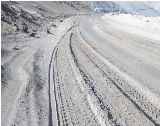
Foto N° 27 Km 27+000 Se observa sector con arenamiento en la plataforma.
