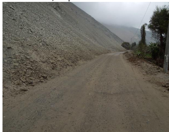
Foto N° 16 Km 14+750. Se aprecia el mal estado de la plataforma en ese sector de la vía.
