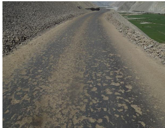
Foto N° 30 Km 31+800 Se aprecia el estado de la superficie de rodadura por la caída de piedras en ese sector.
