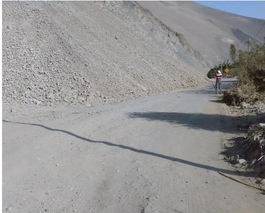
Foto N° 19 Km 14+750 Se aprecia sector en mal estado de la superficie de rodadura.
