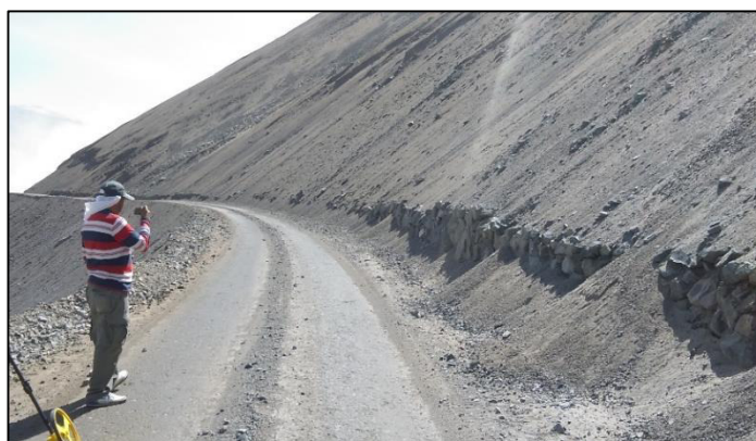
Figura 65: Enrocado destruido por el material de talud inestable
