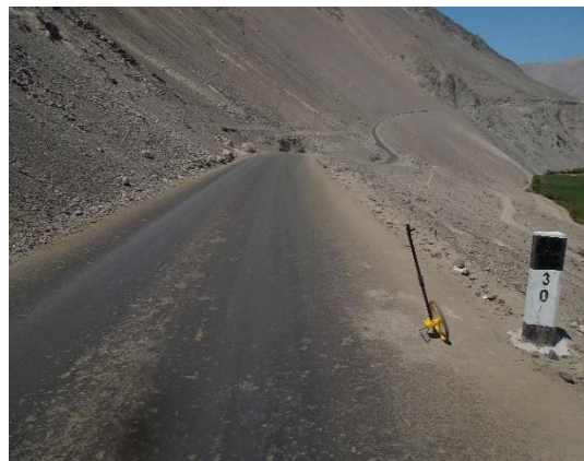
Foto N° 28 Km 30+000 Se aprecia el buen estado de la superficie de rodadura en ese sector.
