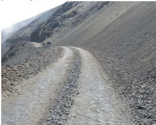
Foto N° 35 Km 31+800 Se aprecia sector con piedras acumuladas en el centro del carril.
