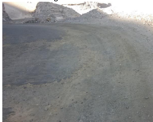
Foto N° 22 Km 25+200 Se observa el mal estado de la superficie de rodadura en sector puntual de curva.
