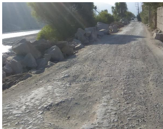
Foto N° 02 Km 05+400 Se observa la plataforma en mal estado, por trabajos de enrocado que han deteriorado la superficie de rodadura.
