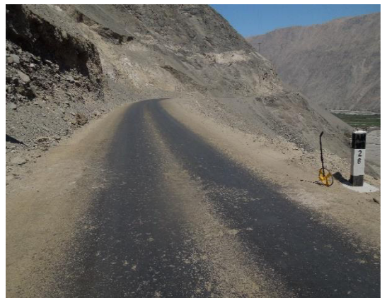
Foto N° 22 Km 26+000. Se aprecia las condiciones de la superficie de rodadura del sector, buen estado.
