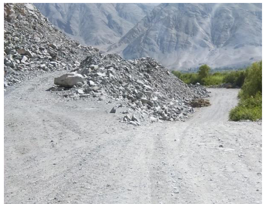
Foto N° 12 Km 12+000 Se aprecia la superficie de rodadura en mal estado en ese sector en pendiente.
