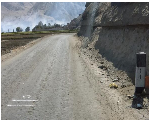
Foto N° 11 Km 11+000 Se aprecia el buen estado de la superficie de rodadura de la vía en ese sector.
