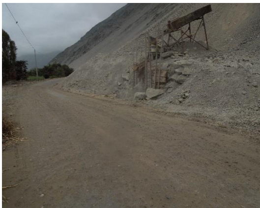
Foto N° 15 Km 14+350 Se aprecia el mal estado de la superficie de rodadura en ese sector de chancadora.
