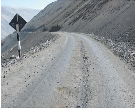
Foto N° 31 Km 30+000 Se aprecia el regular estado de la superficie de rodadura en ese sector.
