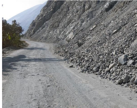
Foto N° 20 Km 15+000 Se puede observar sector de la superficie de rodadura en regular estado.
