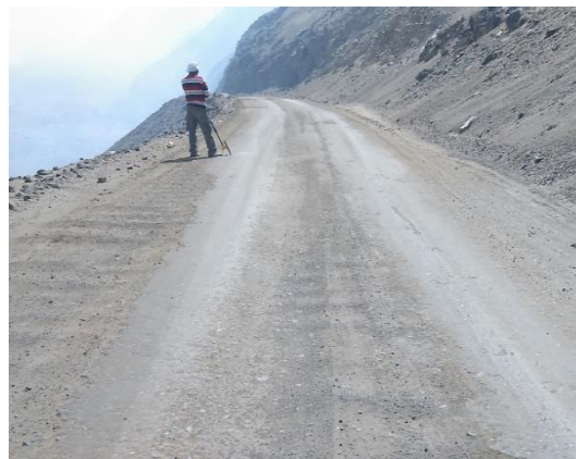
Foto N° 40 Km 34+400 Se aprecia regular estado de la superficie de rodadura, con presencia de encalaminado en los bordes.
