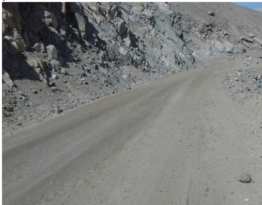
Foto N° 29 Km 29+000 Se observa el regular estado de la superficie de rodadura en ese sector.
