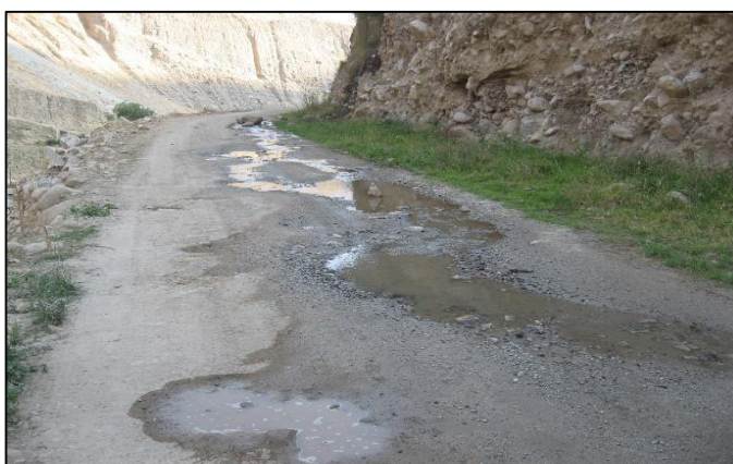
Figura 11: Ejemplo de inadecuado drenaje longitudinal
