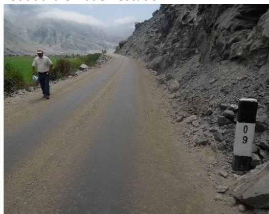
Foto N° 06 Km 09+000. Se aprecia el estado bueno de la superficie de rodadura de la vía en ese sector.
