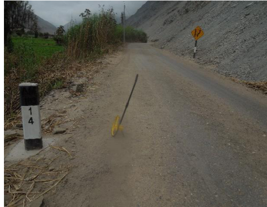
Foto N° 14 Km 14+000. Se aprecia el estado regular de la plataforma en ese sector, en pendiente.
