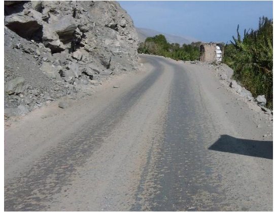
Foto N° 08 Km 09+000 Se aprecia sector en buen estado de la superficie de rodadura.
