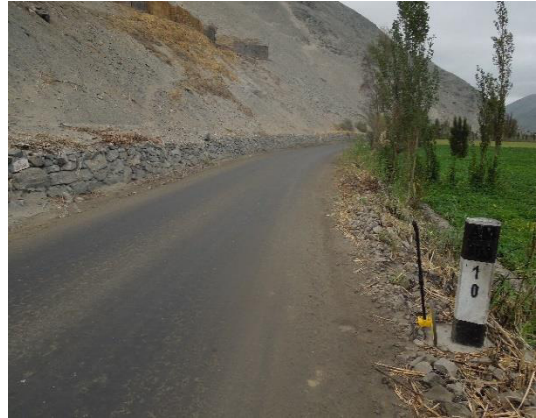
Foto N° 08 Km 10+000. Se observa las condiciones de la superficie de rodadura en ese sector.
