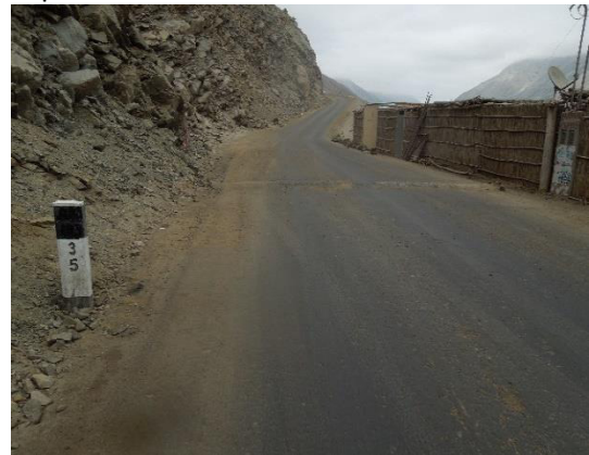
Foto N° 36 Km 35+000 Se aprecia el estado bueno de la superficie de rodadura en ese sector, con presencia de una giba
