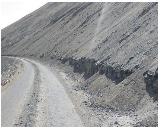
Foto N° 33 Km 31+400 Se aprecia sector del camino con caída de piedras y enrocado destruido.
