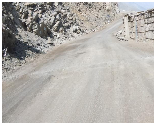
Foto N° 42 Km 35+000 Se aprecia el estado regular de la superficie de rodadura en ese sector, con giba destruida.
