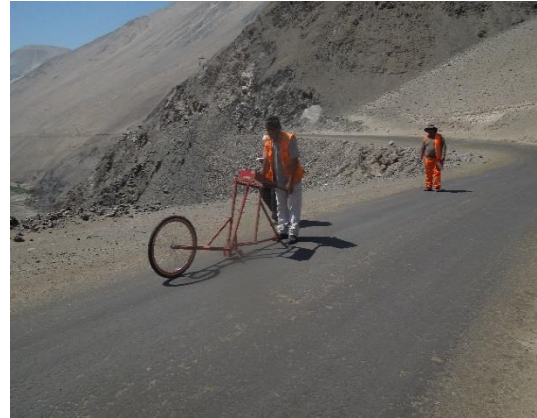
Foto N° 38 Km 23+500 Se aprecia los trabajos de medición de la rugosidad de la superficie de rodadura.
