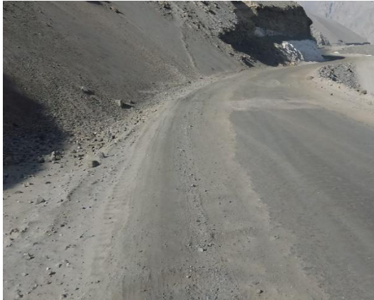
Foto N° 25 Km 26+300 Se puede apreciar el mal estado de la superficie de rodadura en ese sector.
