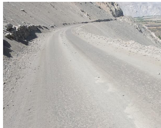
Foto N° 34 Km 31+400 Se aprecia sector con caída de piedras por inestabilidad de talud.
