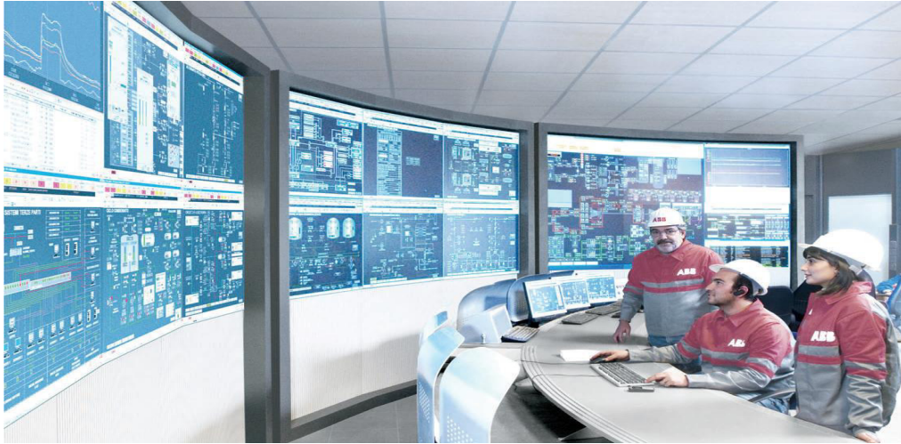
Fig. 17 Sala de supervisión y control industrial
