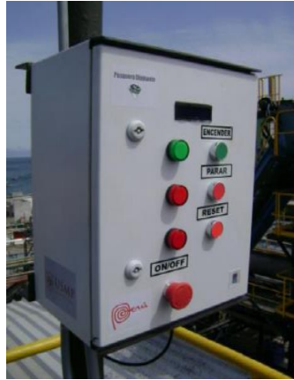
Figura 40 - Interfaz de usuario montado en la parte frontal del gabinete, conformado por 03 lámparas indicadoras de Encendido, Espera y Reset, con sus respectivos pulsadores, y una para de emergencia tipo hongo, para ON/OFF
