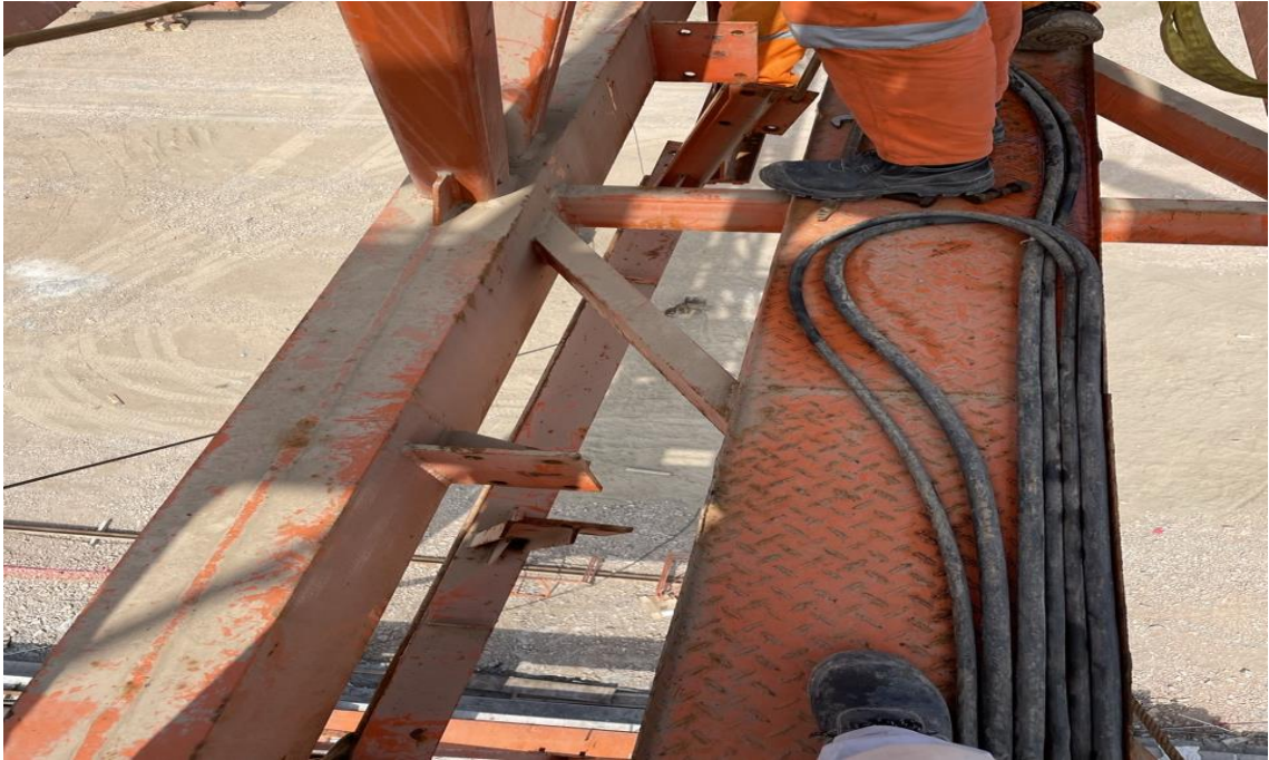
Figura 318. Organización de cables.
