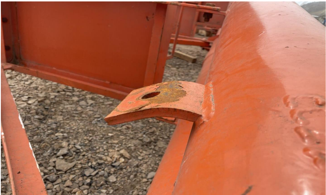
Figura 120. Deformación estructural rígida.
