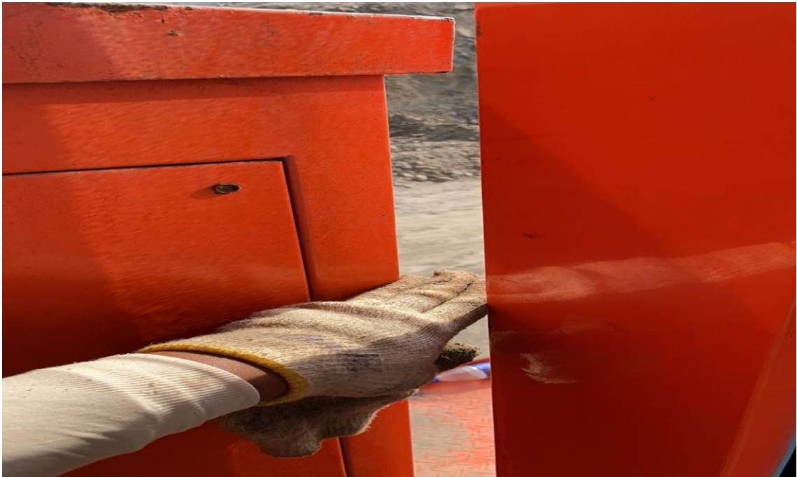
Figura 132. Cabina del gabinete de control eléctrico 01.
