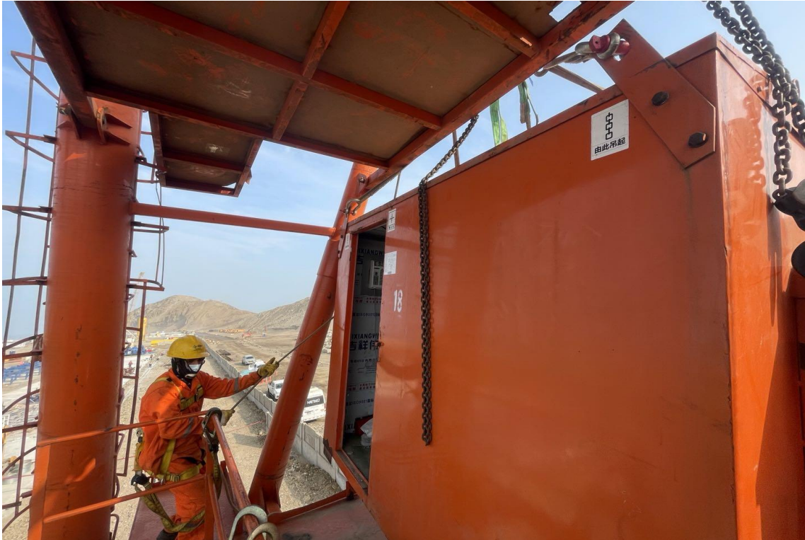
Figura 133. Cabina del gabinete de control eléctrico 02.
