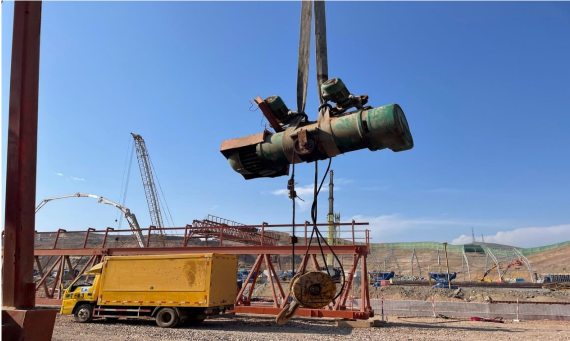
Figura 293. Polipasto eléctrico de elevación.
