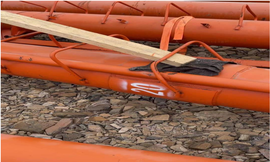
Figura 119. Deformación de escalera.
