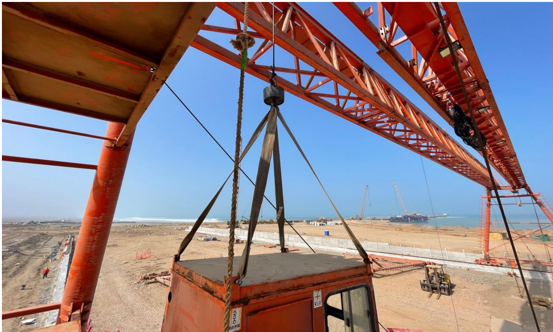
Figura 310. Elevación de cabina.
