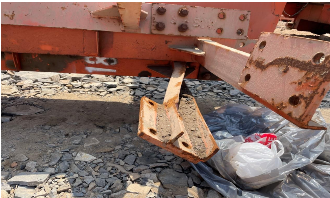
Figura 199. Deformación de la placa de conexión.
