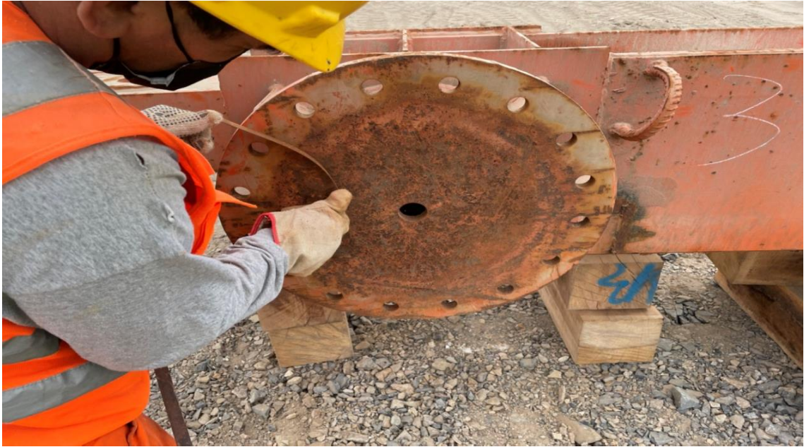
Figura 164. Retiro de óxido.
