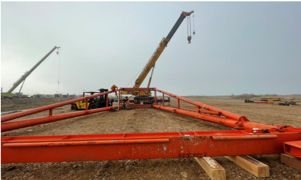
Figura 183. Partes estructurales deformadas 01.
