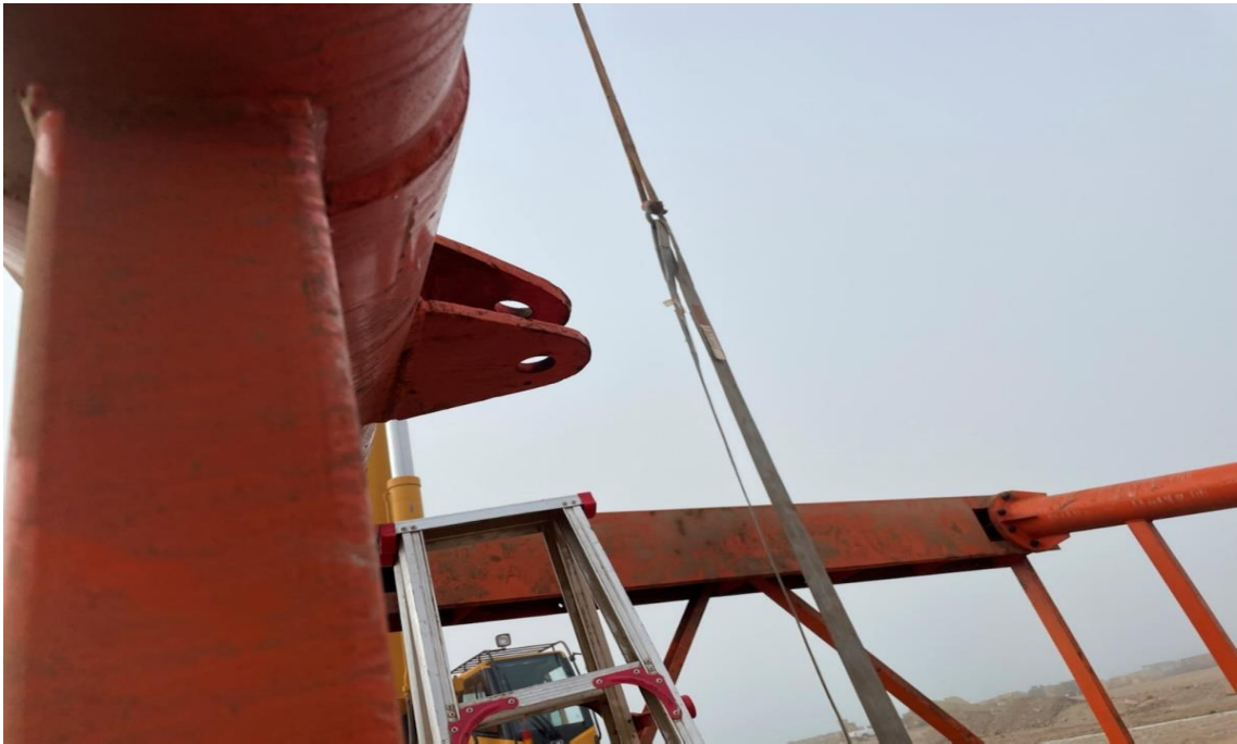
Figura 184. Partes estructurales deformadas 02.
