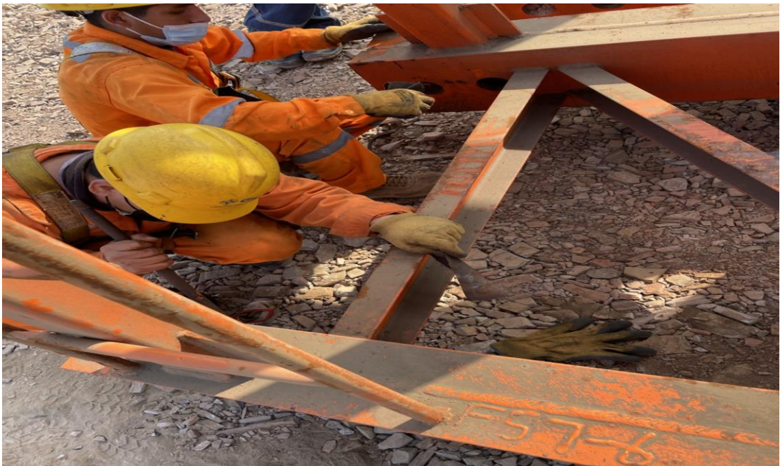
Figura 215. Retiro de óxido.
