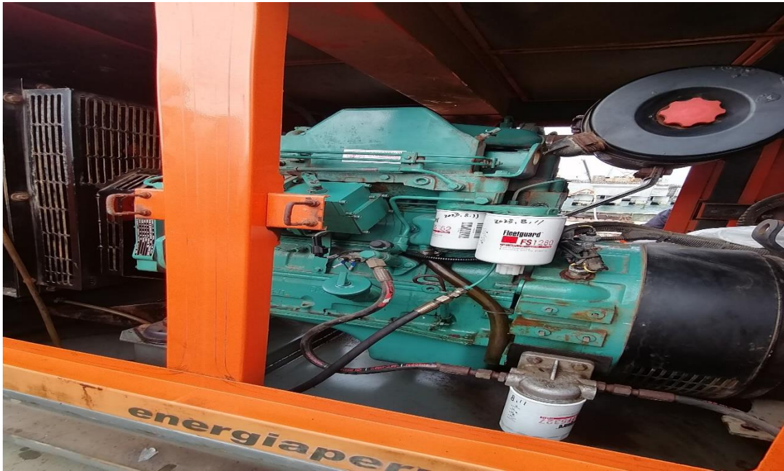
Figura 385. Cambio de filtros del sistema del motor del generador.
