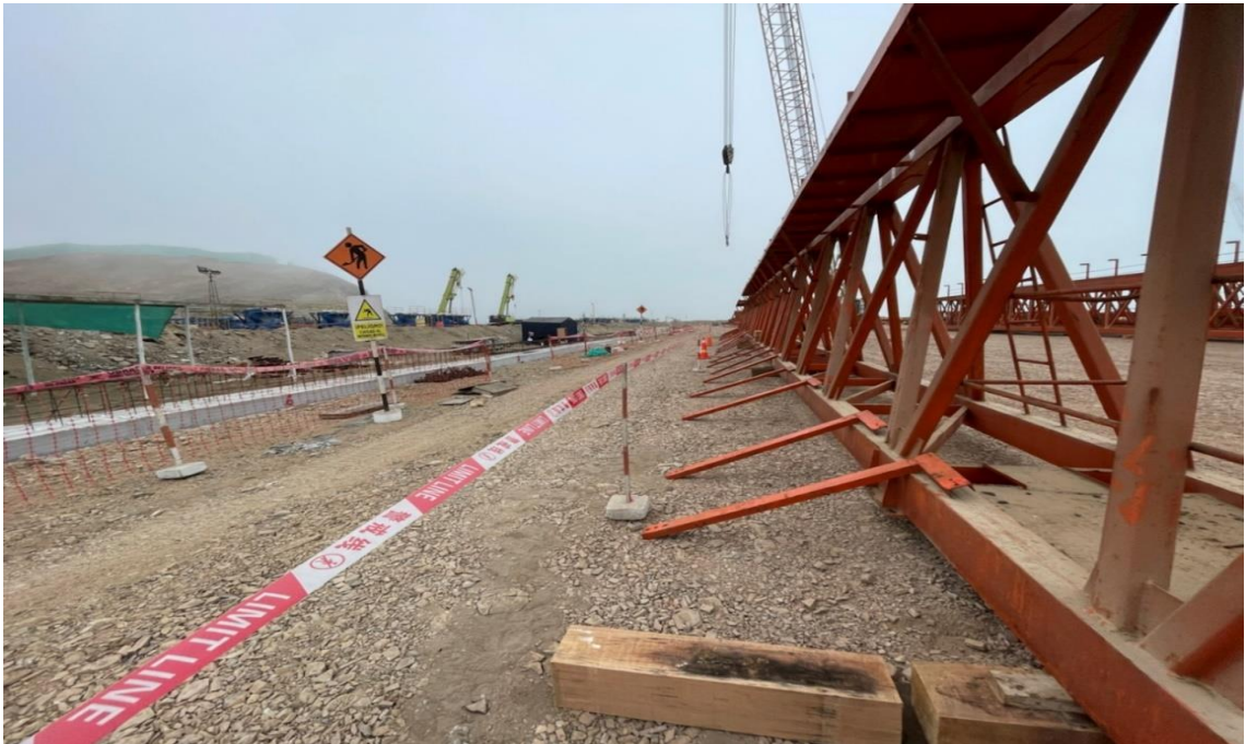
Figura 251. Señalización de los cuerpos de la grúa pórtica.
