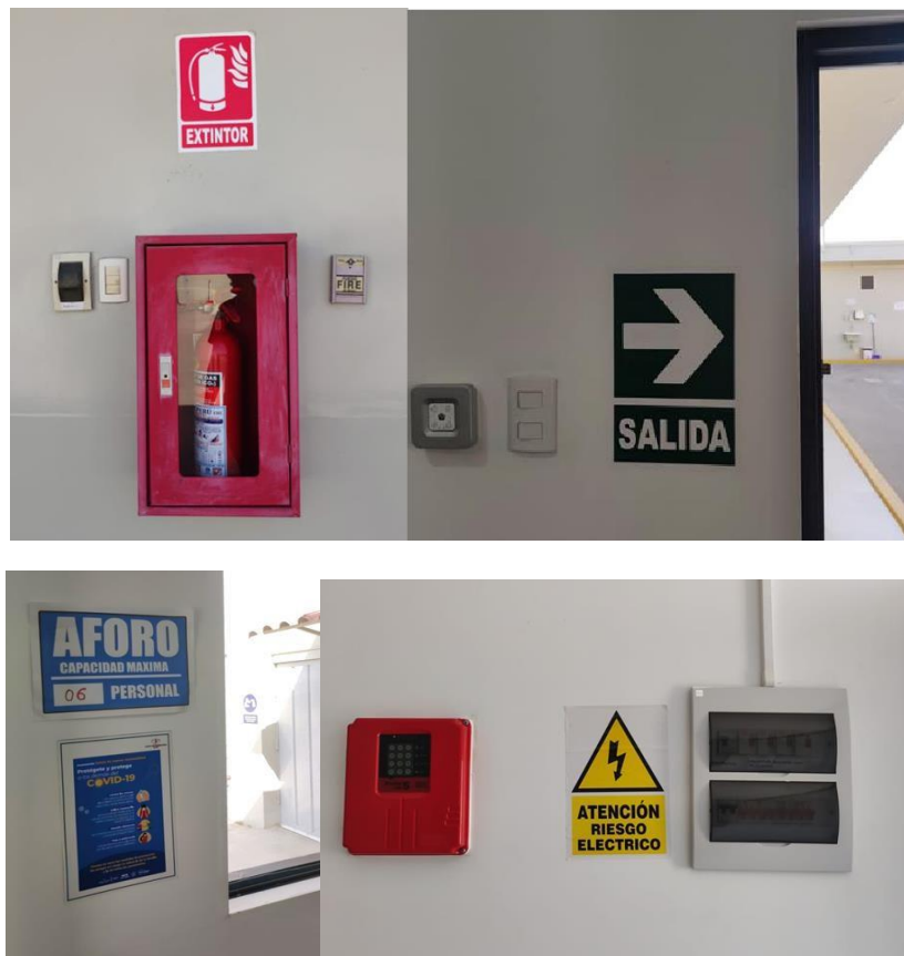
Figura 66. Evidencia de señalización
