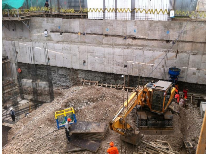
1°Visita: Desorden en acopio de desmonte y RCD.
