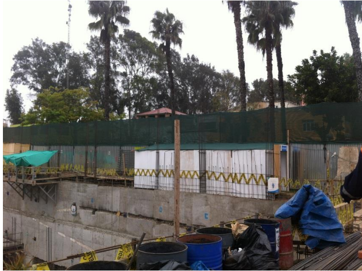
1°Visita: Falta de señalización de contenedores de residuos.
