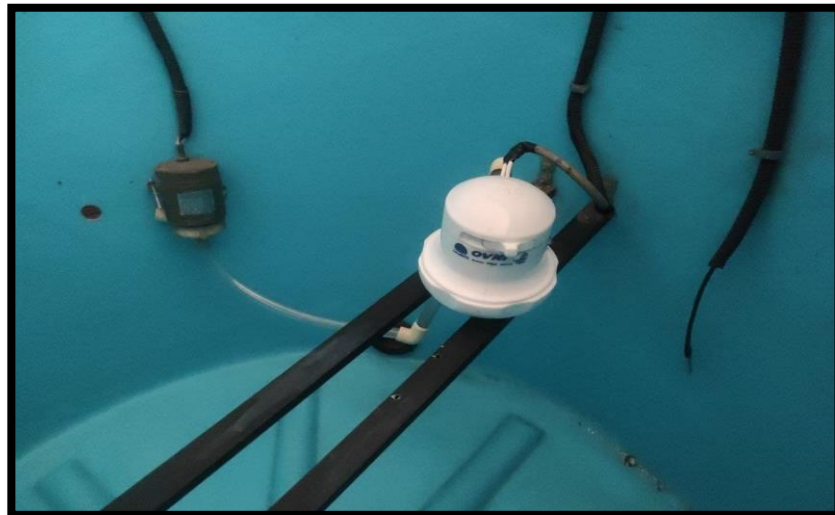
Figura 72. Terma eléctrica instalada
