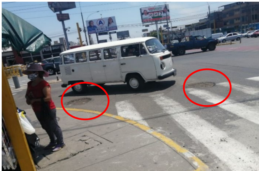
Figura 5. Falta de mantenimiento de las vías.
