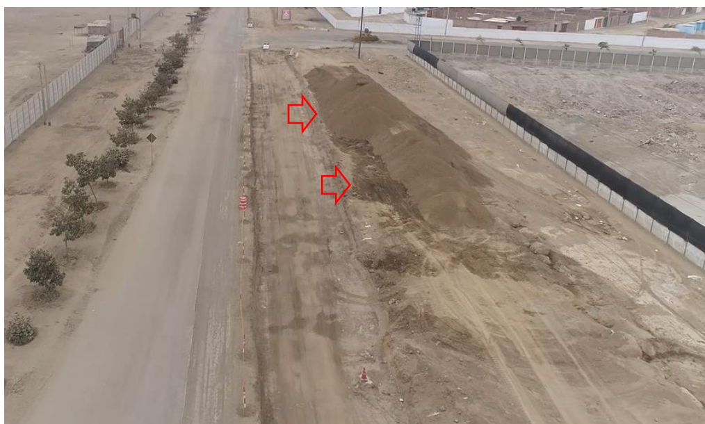
Figura 84. Descarga de Material en lugar inadecuado Prog. 10+500 MD
