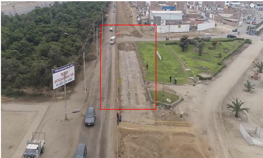
Figura 85. Excavación incompleta Prog. 4+400 – 4+425
