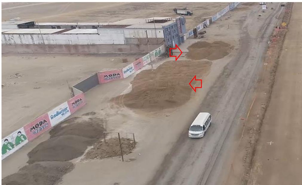
Figura 83. Descarga de Material en lugar inadecuado Prog. 1+200 – MI
