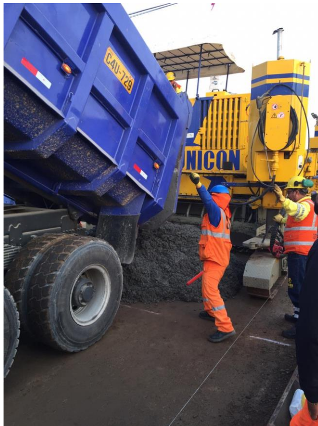
Fotografía 42. Colocación de Concreto Premezclado con Volquete de 24 m 3 – Pavimentadora de Encofrado deslizante
