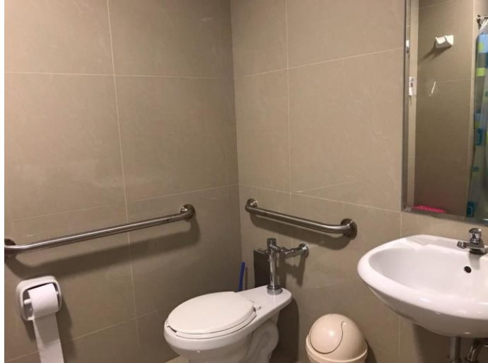
Figura 28: Baño de dormitorio, Casa Magia
