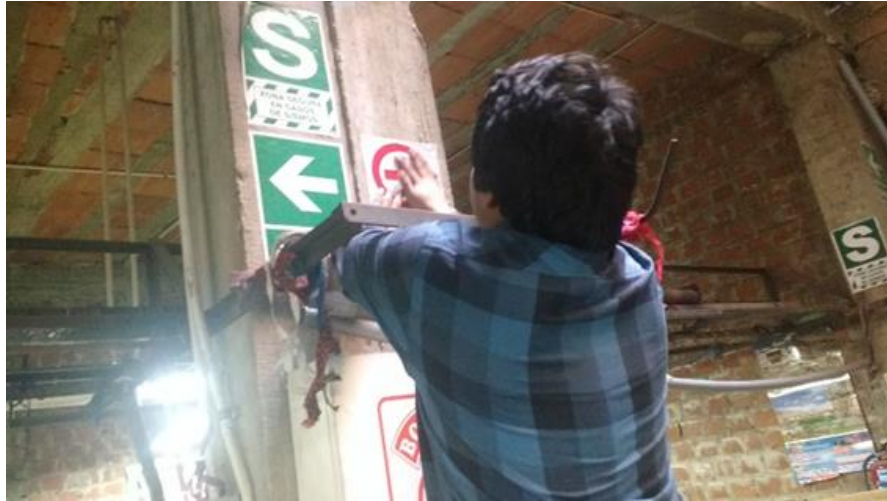
Figura 105. Colocación de señales de seguridad.
