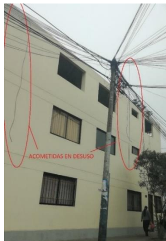
Figura 1: Imagen de cableado tomada en el Centro Histórico de Barranco
