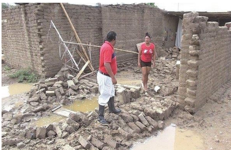
Figura 2: Colapso de viviendas debido al fenómeno del niño.
