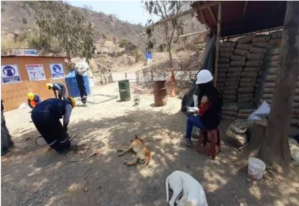
Fotografía 19: Se observa la aplicación de la carta balance en la habilitación del acero para columnas.
