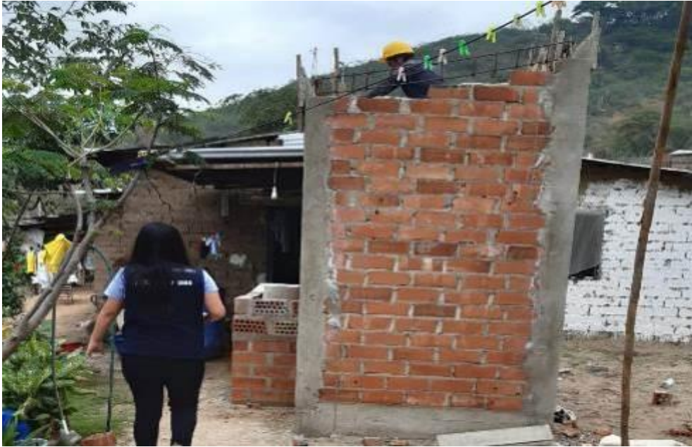
Fotografía 35: Se observa la colocación del acero de la viga en M-36, caserío Cumbil Alto.
