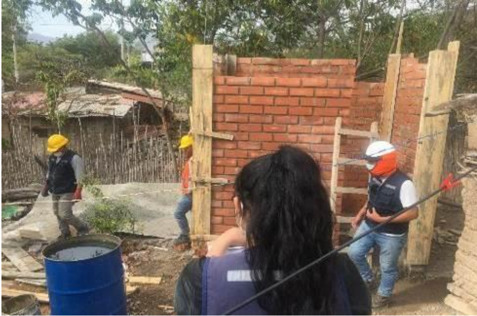
Fotografía 33: Se observa la aplicación de la carta balance en el vaciado de concreto en columnas en M-38, caserío Cumbil Alto.
