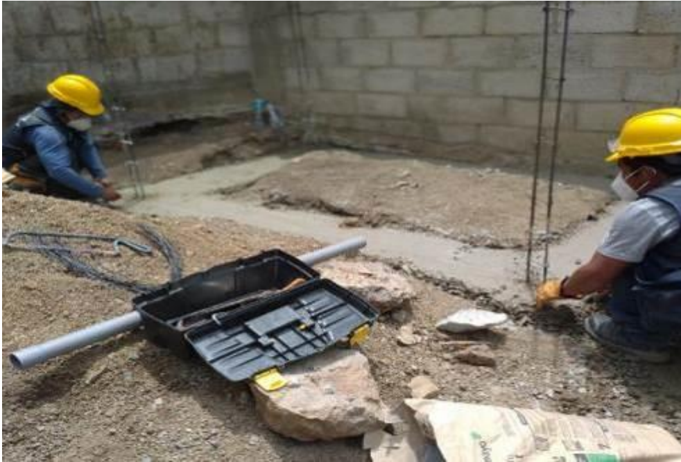
Fotografía 9: Se observa en otra UBS la cimentación vaciada de concreto simple.
