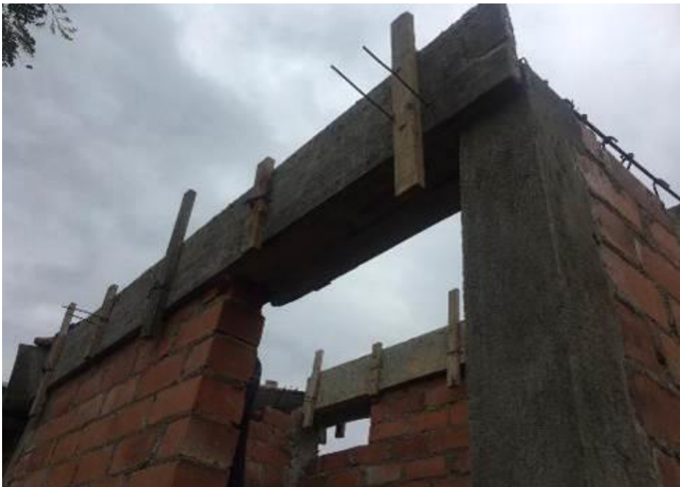
Fotografía 36: Se observa el encofrado de la viga en M-36, caserío Cumbil Alto.
