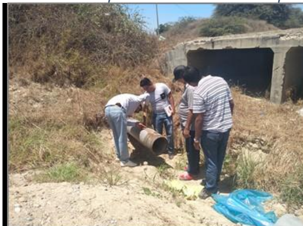
Fotografía N° 3: Tubería expuesta en la línea de impulsión existente
