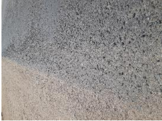
Fotografía N° 37. Desprendimiento de agregados Progresiva Km 0+850 – 0+900
