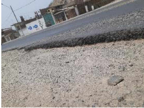
Fotografía N° 61. Desnivel carril berma Progresiva Km 2+300 – 2+350
