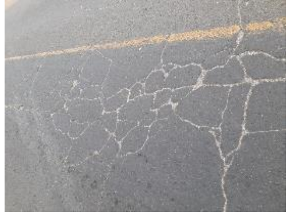
Fotografía N° 20. Piel de cocodrilo Progresiva Km 0+200 – 0+250
