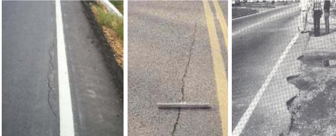
Figura 20. Grieta tipo borde de baja, media y alta severidad
