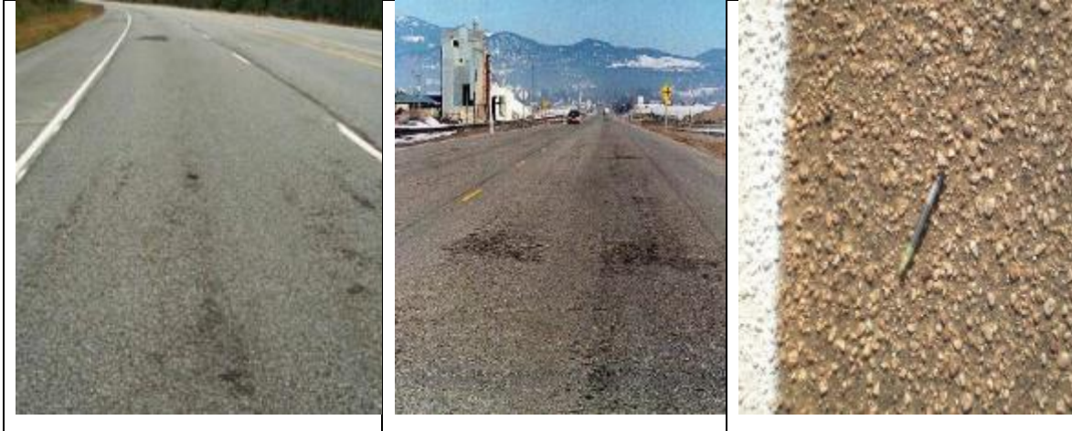
Figura 32. Desprendimiento del agregado
