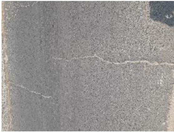
Fotografía N° 63. Grietas longitudinales y transversales Progresiva Km 2+350 – 2+400
