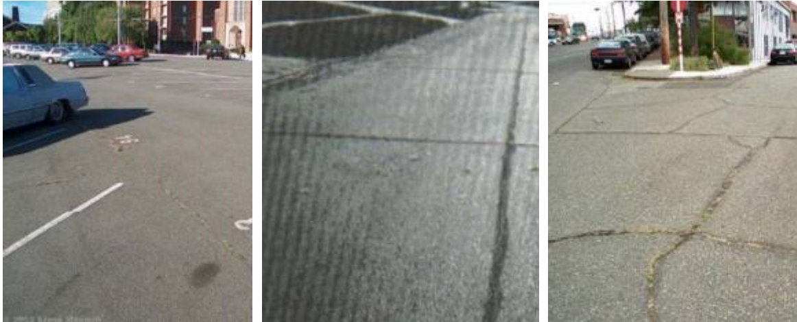
Figura 21. Grieta tipo reflexión de junta de baja, media y alta severidad
