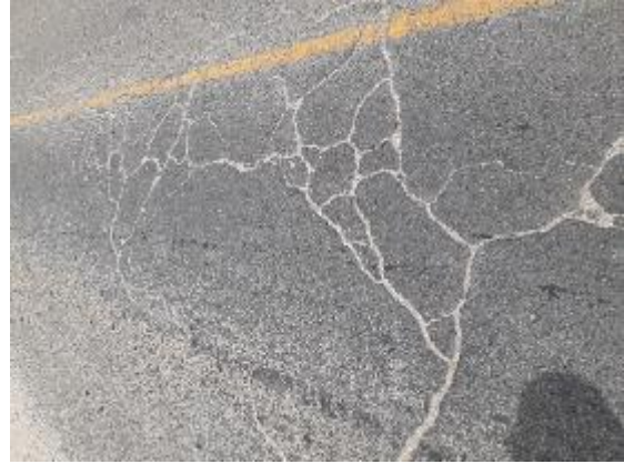
Fotografía N° 26. Piel de cocodrilo Progresiva Km 0+300 – 0+350
