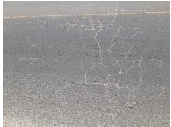
Fotografía N° 22. Piel de cocodrilo Progresiva Km 0+250 – 0+300
