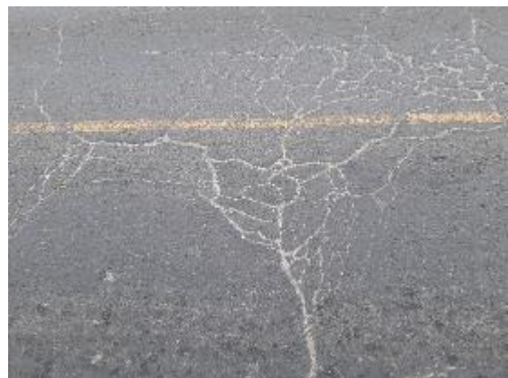
Fotografía N° 06. Piel de cocodrilo Progresiva Km 0+100 – 0+150
