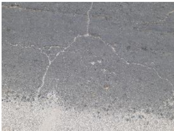
Fotografía N° 11. Grieta parabólica Progresiva Km 0+100 – 0+150
