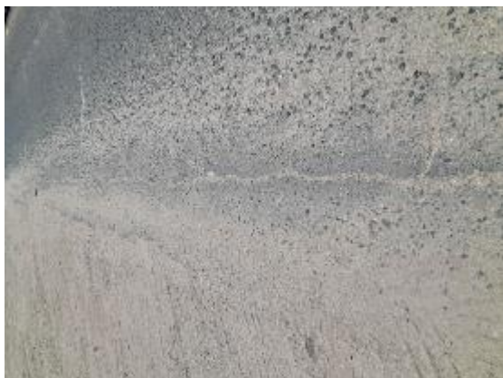
Fotografía N° 47. Grieta de borde Progresiva Km 1+600 – 1+650
