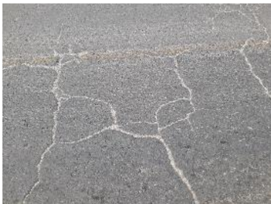
Fotografía N° 05. Piel de cocodrilo Progresiva Km 0+050 – 0+100
