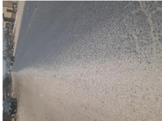
Fotografía N° 46. Desprendimiento de agregados Progresiva Km 1+600 – 1+650
