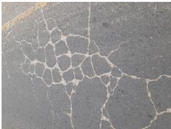
Fotografía N° 23. Piel de cocodrilo Progresiva Km 0+250 – 0+300
