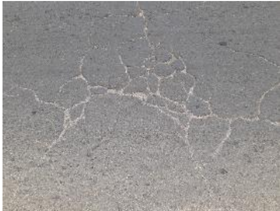
Fotografía N° 21. Piel de cocodrilo Progresiva Km 0+200 – 0+250
