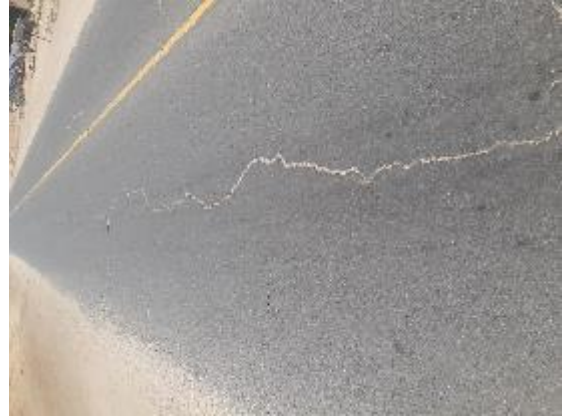
Fotografía N° 50. Grietas longitudinales y transversales Progresiva Km 2+050 – 2+100
