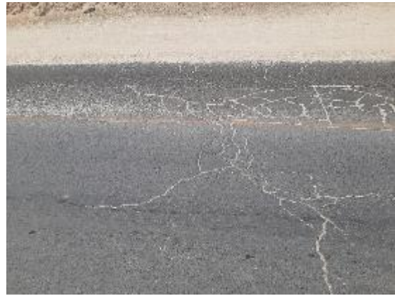
Fotografía N° 64. Piel de cocodrilo Progresiva Km 2+350 – 2+400
