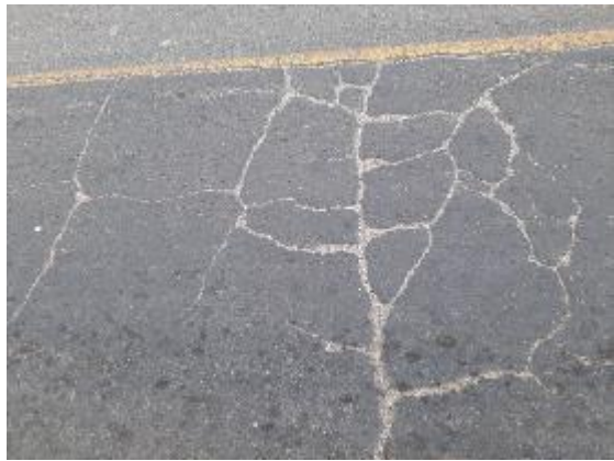
Fotografía N° 15. Piel de cocodrilo Progresiva Km 0+150 – 0+200
