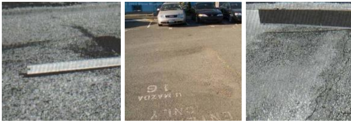
Figura 17. Abultamientos y hundimientos de baja, media y alta severidad
