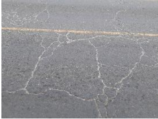
Fotografía N° 07. Piel de cocodrilo Progresiva Km 0+100 – 0+150
