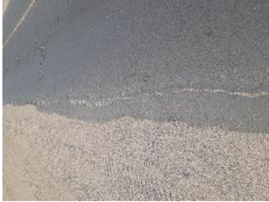
Fotografía N° 55. Grieta de borde Progresiva Km 2+150 – 2+200
