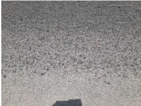
Fotografía N° 03. Desprendimiento de agregados Progresiva Km 0+000 – 0+050
