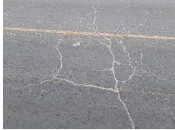
Fotografía N° 08. Piel de cocodrilo Progresiva Km 0+100 – 0+150
