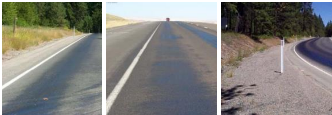
Figura 15. Exudación de baja, media y alta severidad
