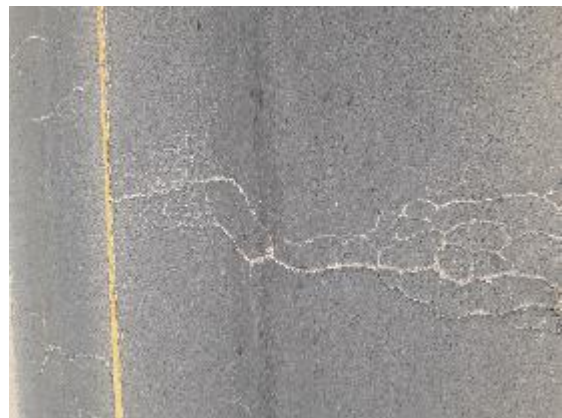
Fotografía N° 54. Piel de cocodrilo Progresiva Km 2+150 – 2+200
