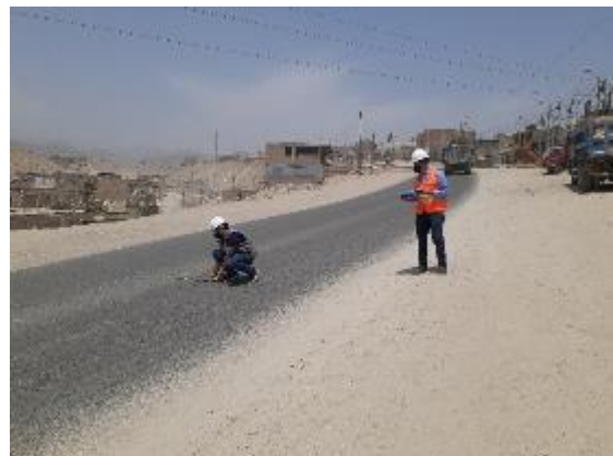
Fotografía N° 66. Identificación de grieta transversal
