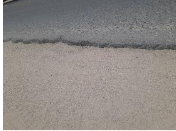
Fotografía N° 44. Desnivel carril berma Progresiva Km 1+550 1+600
