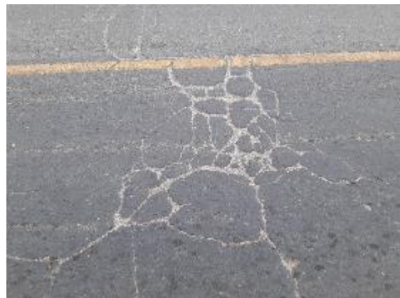
Fotografía N° 12. Piel de cocodrilo Progresiva Km 0+150 – 0+200
