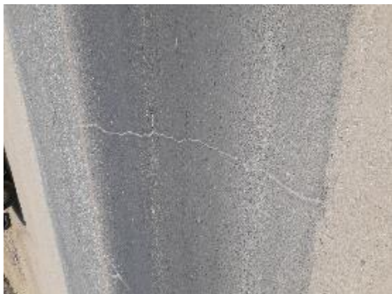
Fotografía N° 29. Grietas longitudinales y transversales Progresiva Km 0+400 – 0+450
