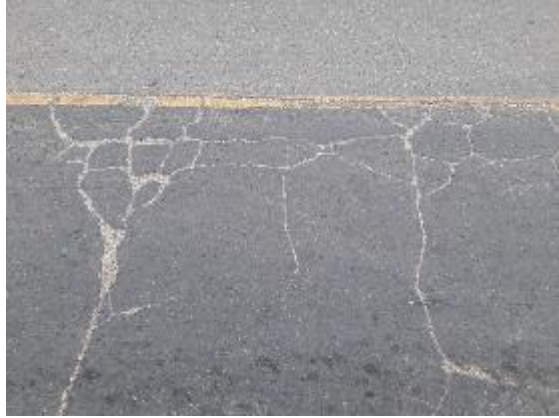
Fotografía N° 13. Piel de cocodrilo Progresiva Km 0+150 – 0+200
