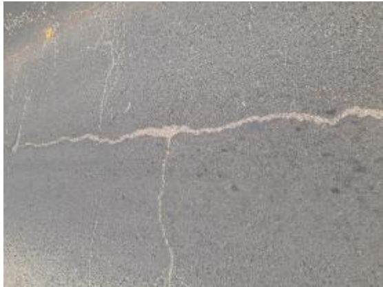
Fotografía N° 45. Grietas longitudinales y transversales Progresiva Km 1+600 – 1+650
