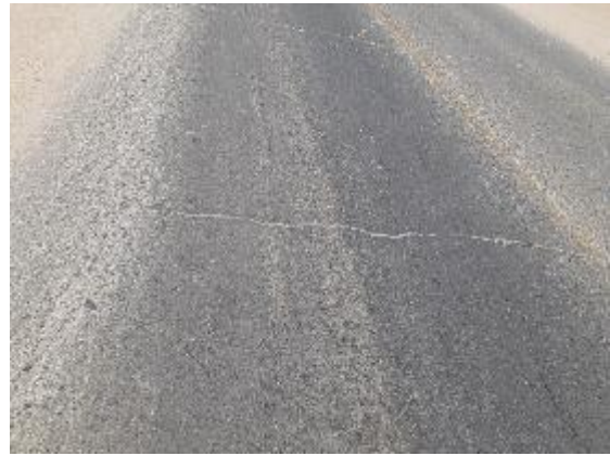
Fotografía N° 28. Grietas longitudinales y transversales Progresiva Km 0+300 – 0+350
