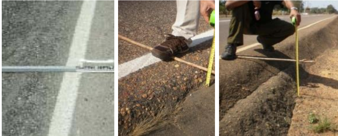
Figura 22. Desnivel de baja, media y alta severidad
