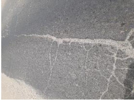
Fotografía N° 25. Grietas longitudinales y transversales Progresiva Km 0+300 – 0+350
