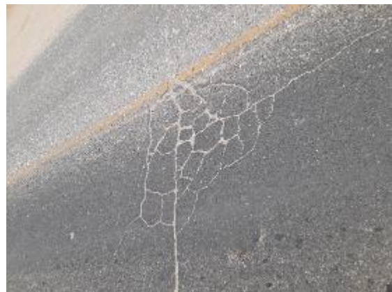
Fotografía N° 30. Piel de cocodrilo Progresiva Km 0+400 – 0+450
