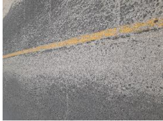
Fotografía N° 62. Desprendimiento de agregados Progresiva Km 2+300 – 2+350
