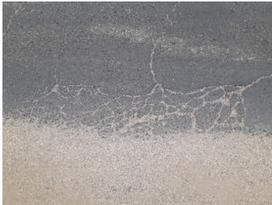
Fotografía N° 39. Piel de cocodrilo Progresiva Km 0+900 – 0+950
