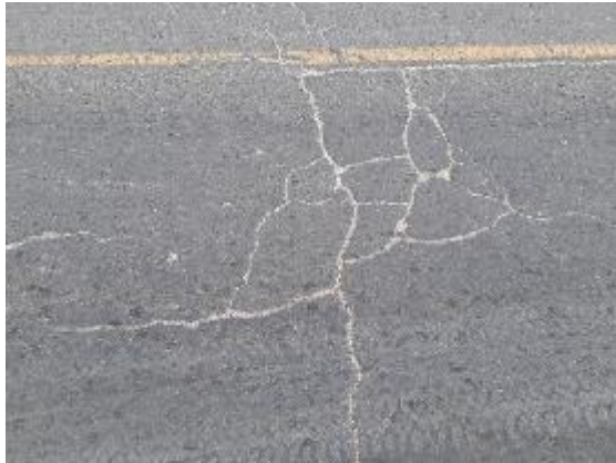
Fotografía N° 09. Piel de cocodrilo Progresiva Km 0+100 – 0+150
