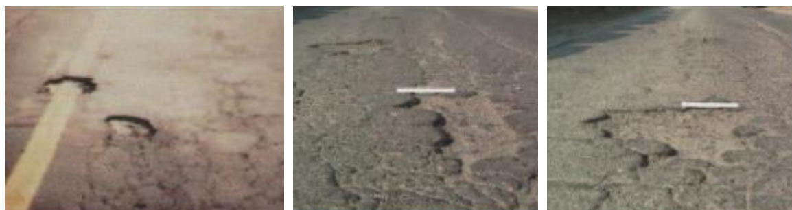
Figura 26. Huecos de baja, media y alta severidad
