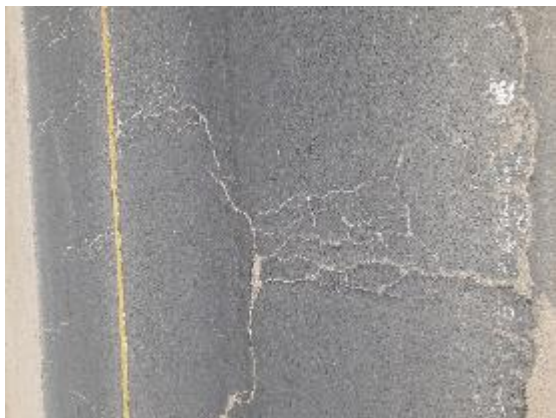
Fotografía N° 53. Piel de cocodrilo Progresiva Km 2+100 – 2+150
