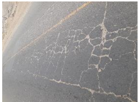
Fotografía N° 24. Piel de cocodrilo Progresiva Km 0+250 – 0+300
