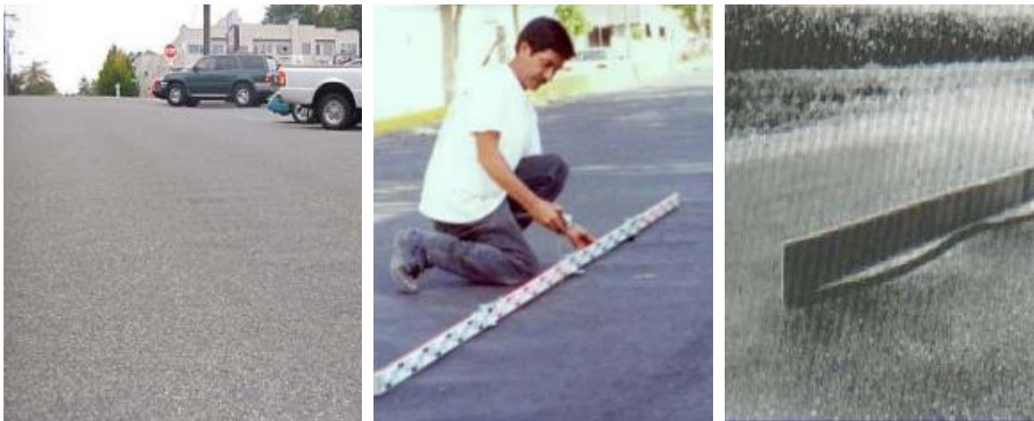
Figura 18. Corrugación de baja, media y alta severidad
