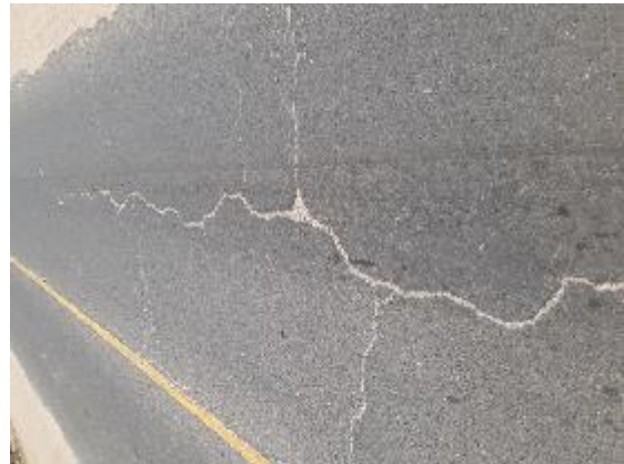
Fotografía N° 52. Grietas longitudinales y transversales Progresiva Km 2+100 – 2+150
