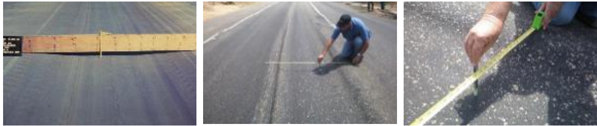
Figura 28. Ahuellamiento de baja, media y alta severidad
