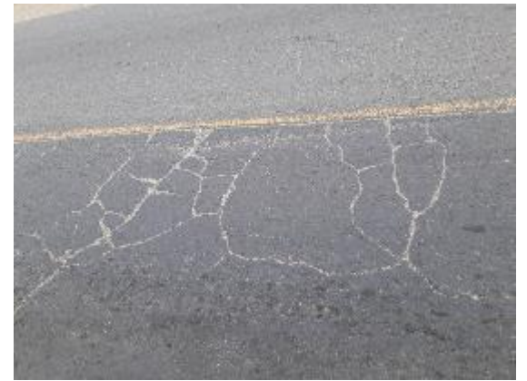
Fotografía N° 16. Piel de cocodrilo Progresiva Km 0+150 – 0+200
