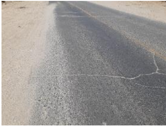
Fotografía N° 27. Grietas longitudinales y transversales Progresiva Km 0+300 – 0+350
