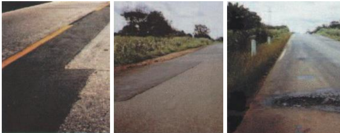
Figura 24. Parches y acometidas de baja, media y alta severidad
