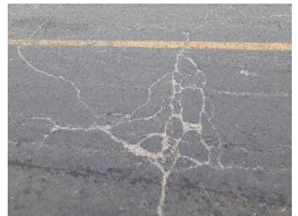
Fotografía N° 18. Piel de cocodrilo Progresiva Km 0+150 – 0+200
