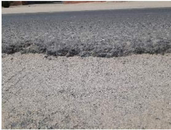
Fotografía N° 33. Desnivel carril berma Progresiva Km 0+500 – 0+550
