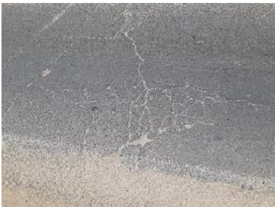
Fotografía N° 59. Piel de cocodrilo Progresiva Km 2+200 – 2+250
