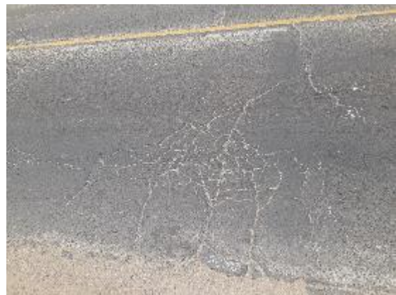
Fotografía N° 60. Piel de cocodrilo Progresiva Km 2+250 – 2+300
