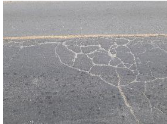
Fotografía N° 10. Piel de cocodrilo Progresiva Km 0+100 – 0+150
