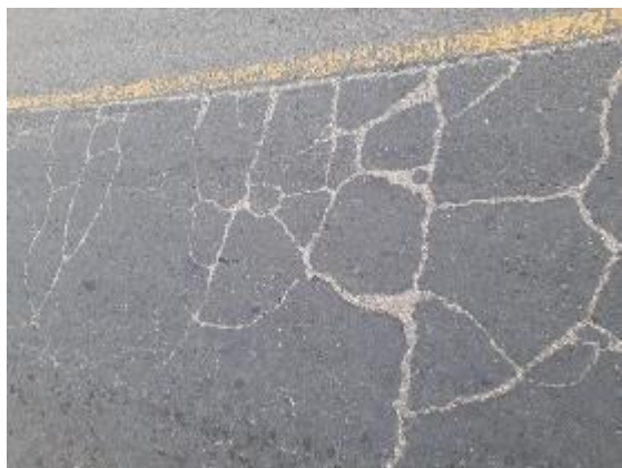
Fotografía N° 17. Piel de cocodrilo Progresiva Km 0+150 – 0+200
