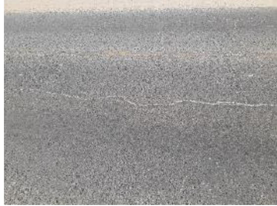
Fotografía N° 38. Grietas longitudinales y transversales Progresiva Km 0+850 – 0+900
