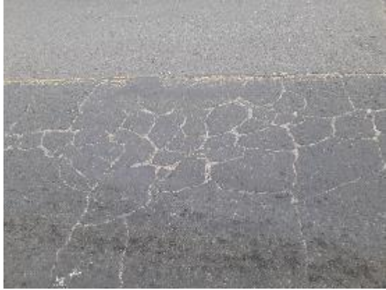
Fotografía N° 19. Piel de cocodrilo Progresiva Km 0+200 – 0+250
