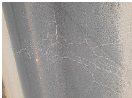
Fotografía N° 48. Piel de cocodrilo Progresiva Km 1+700 – 1+750
