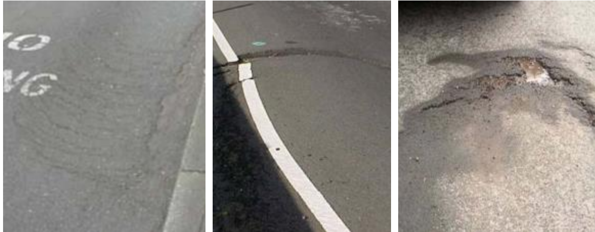
Figura 30. Grietas parabólicas de baja, media y alta severidad
