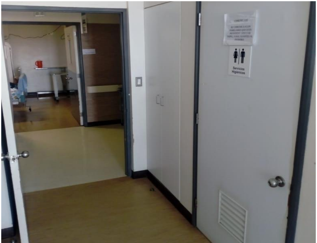
FOTOGRAFIA 04: Se observa que no se permite el uso del servicio higiénico en los cuartos de hospitalización, debido al mal estado en que se encuentran.
