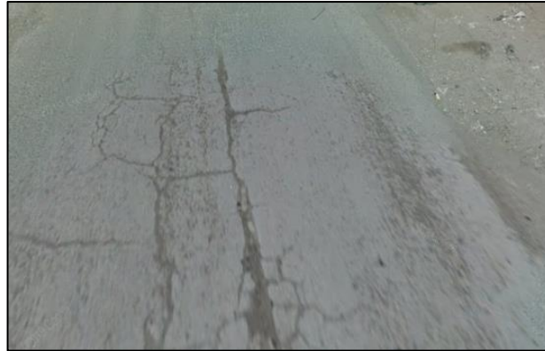
Figura 4: Presencia de grietas en la pista.
